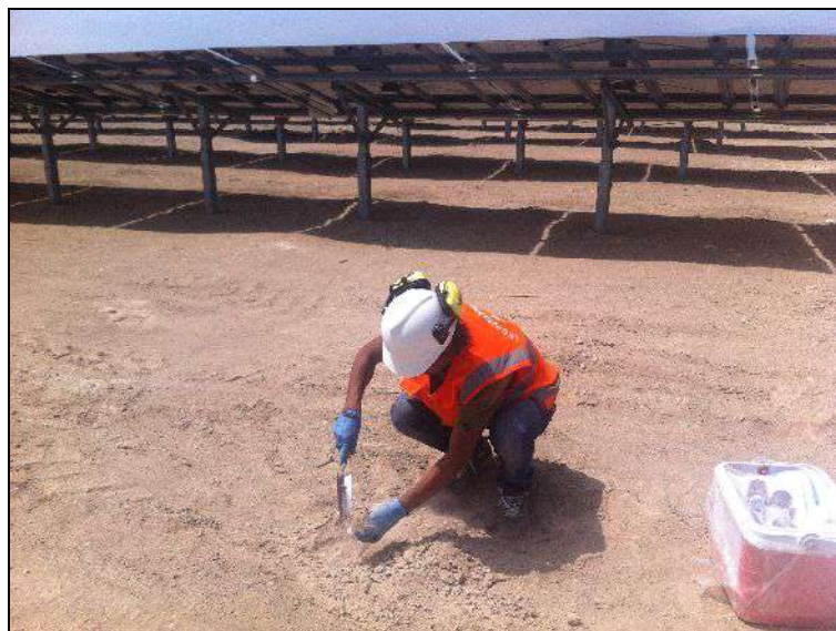
Foto N° 02 - Estación de monitoreo S-2M
