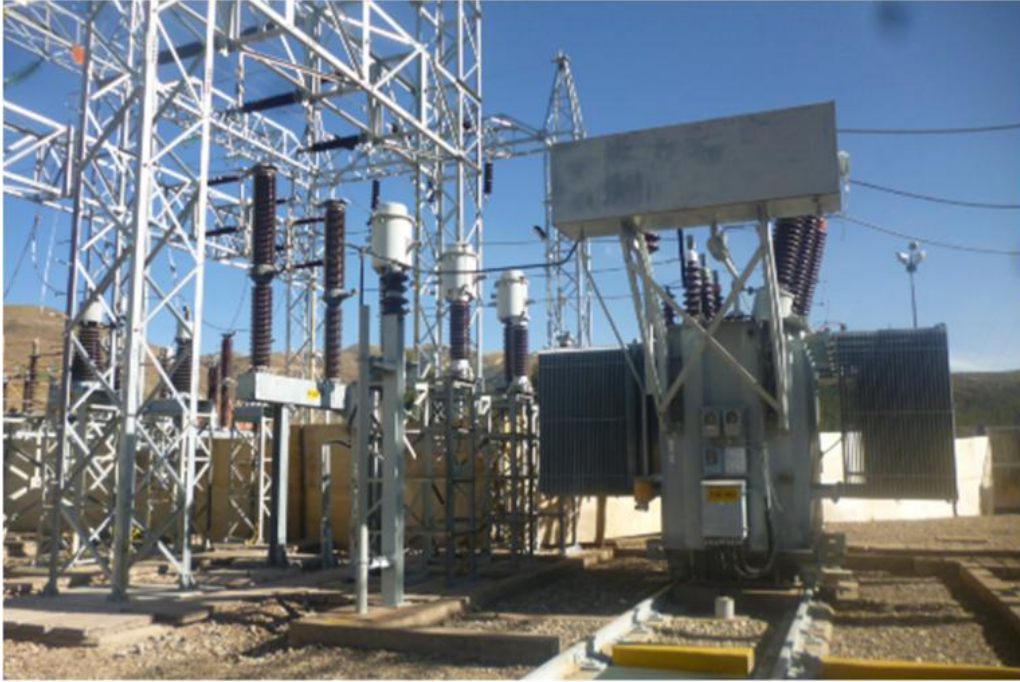
Fotografía 2.4.1.2-1 Celda de llegada 66 kV (desde transformador T46-162)
