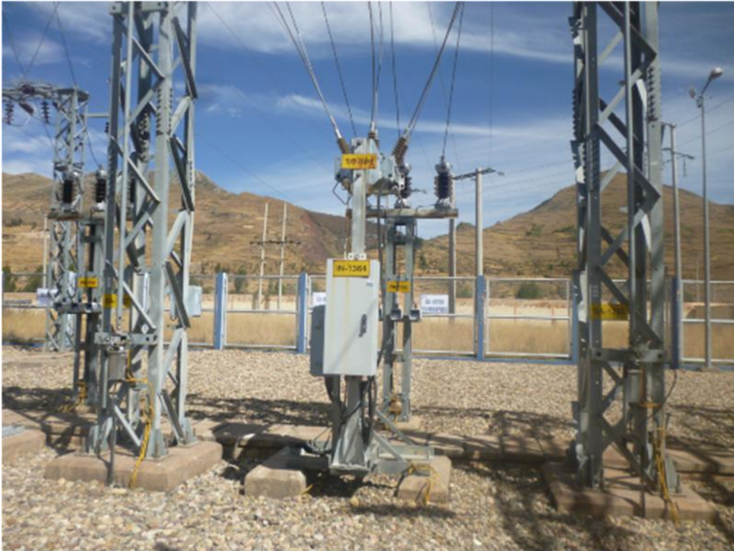
Fotografía 2.4.1.3-4 Celda de salida CL-0230 hacia Combapata
