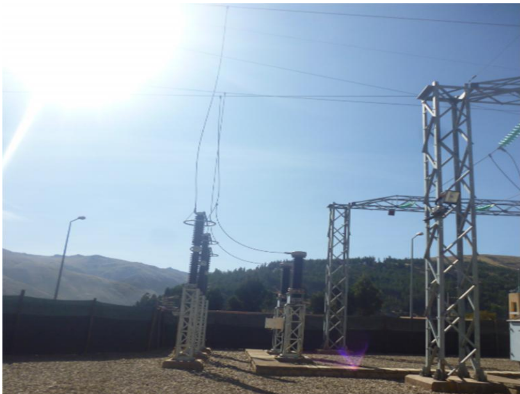
Fotografía 2.4.1.1-2 Celda de línea L-1005 (S.E. Tintaya)
