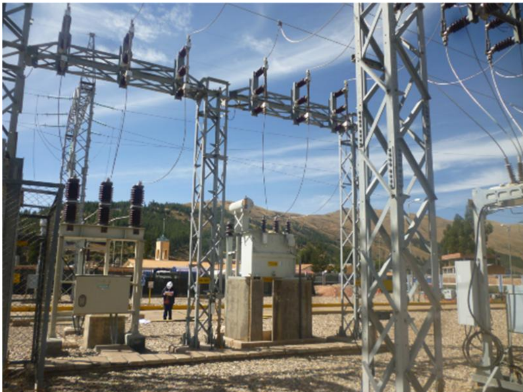
Fotografía 2.4.1.3-3 Celda de salida hacia transformador Zig-Zag
