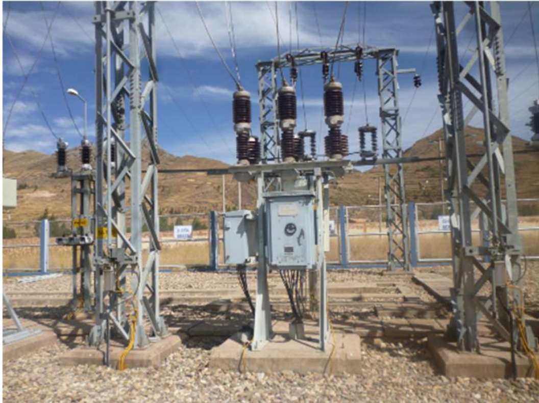
Fotografía 2.4.1.3-6 Celda de salida CL-0233 hacia Chamaca
