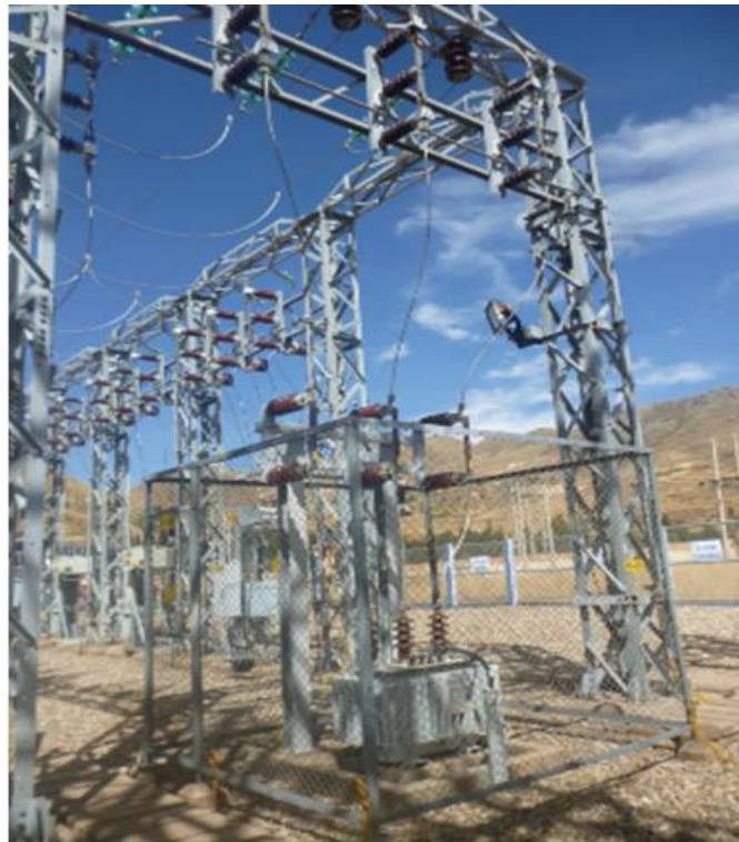
Fotografía 2.4.1.3-1 Celda de salida hacia transformador de SS.AA
