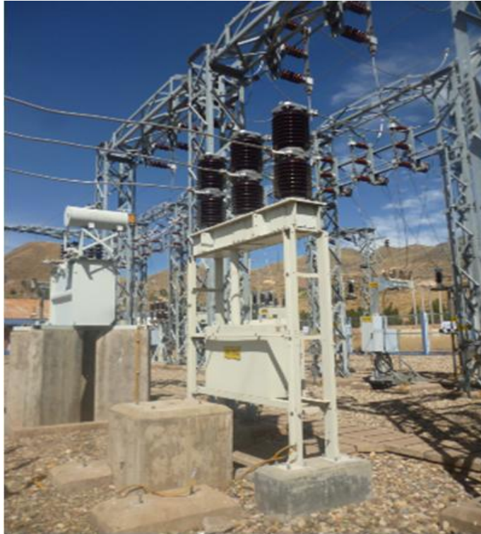
Fotografía 2.4.1.3-2 Celda de Llegada desde Transformador de Potencia T46-162
