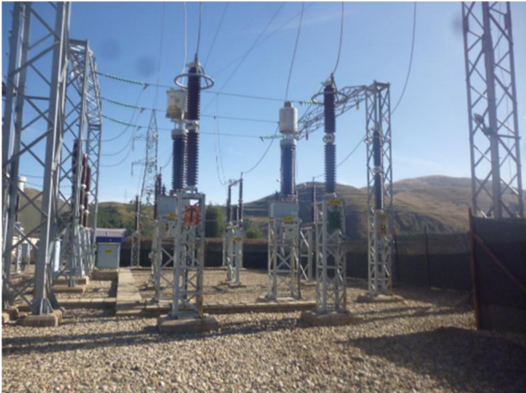
Fotografía 2.4.1.1-1 Celda de línea L-1005 (S.E. Quencoro)
