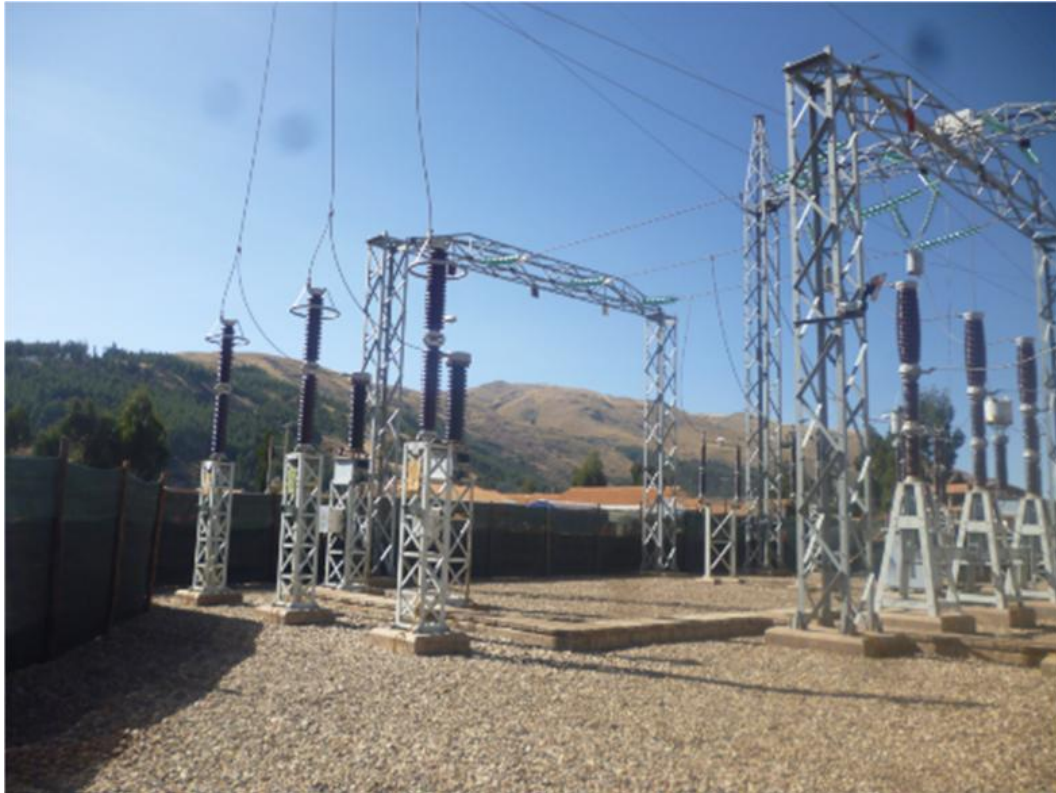
Fotografía 2.4.1.1-3 Barra en 138 kV
