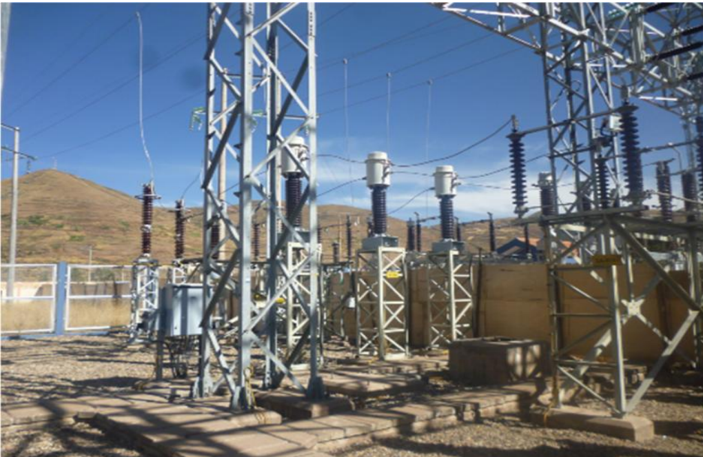
Fotografía 2.4.1.2-2 Celda de línea L-0630 (Hacia Sicuani)
