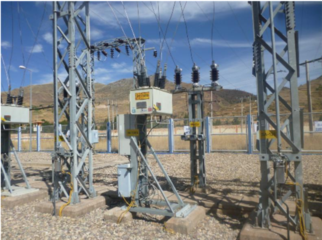
Fotografía 2.4.1.3-5 Celda de salida CL-0231 hacia Ttio
