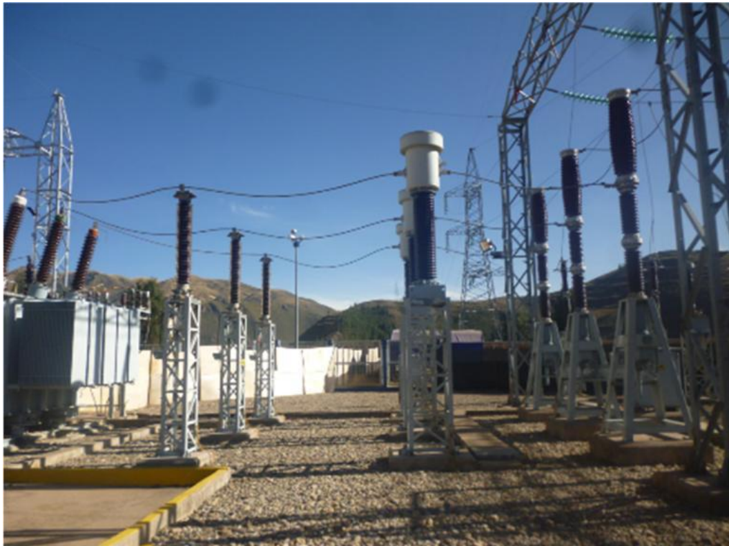
Fotografía 2.4.1.1-4 Celda de transformación 138 kV
