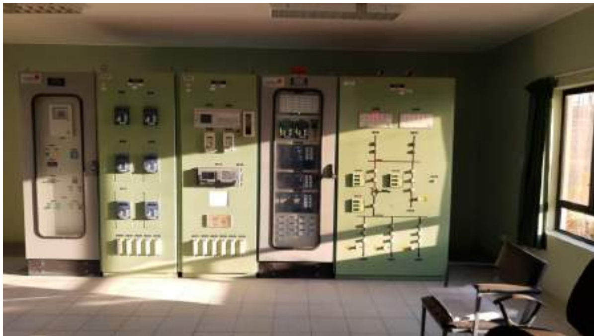
Fotografía N° 3.11 Vista de tableros de control
