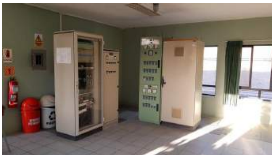
Fotografía N° 3.12 Vista de tableros de control
