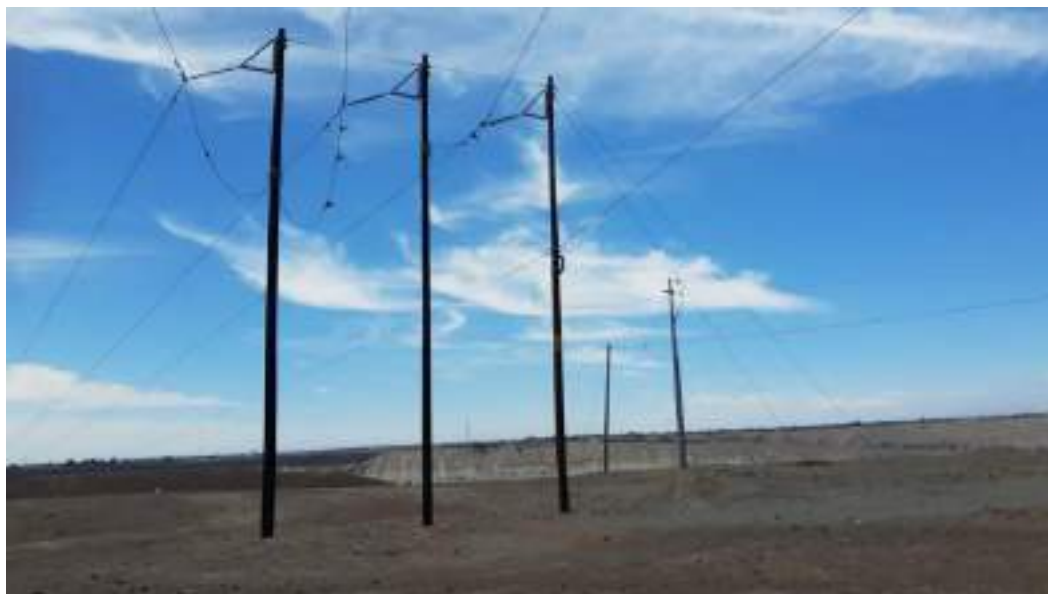
Fotografía N° 3.8 Vista de la última estructura de la línea de transmisión a la llegada a la SE Majes
