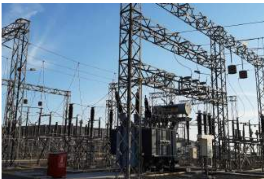
Fotografía N° 3.14 Vista del transformador
