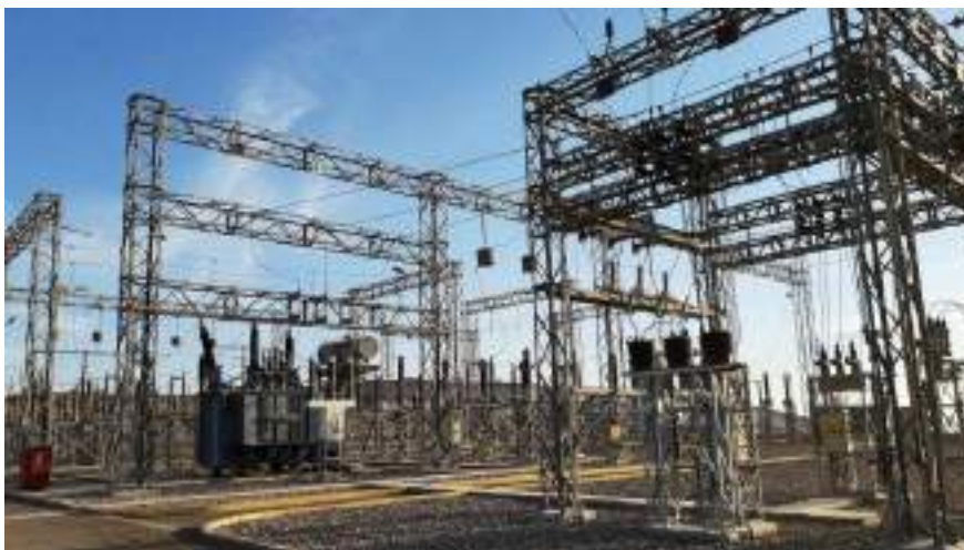
Fotografía N° 3.13 Vista del patio de llaves
