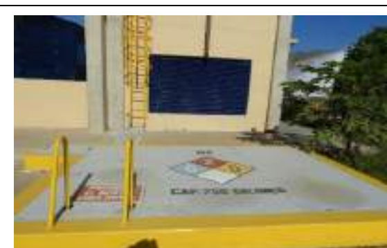
Fotografía 6.2-10 Tanque de combustible (PAD-CHG-07)
