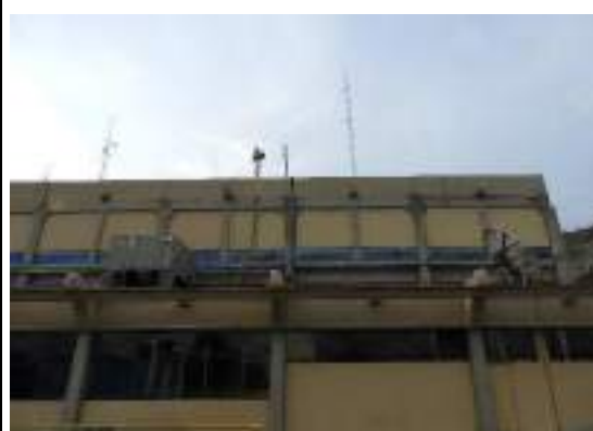
Fotografía 6.2-4 Estación de telecomunicación (PAD-CHG-03)
