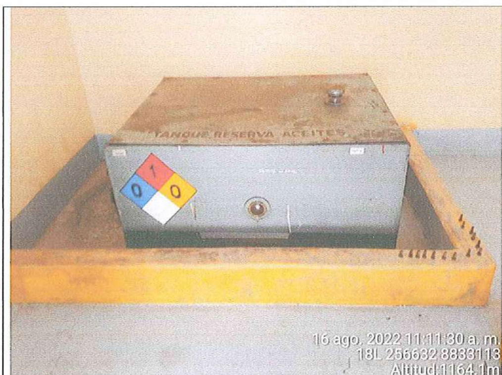
Fotografía N° 19: Almacén de lubricantes de la zona de la Bocatoma de la C.H. Cahua, donde se ubica el tanque de aceites, el mismo que según el administrado, se encuentra en desuso.
