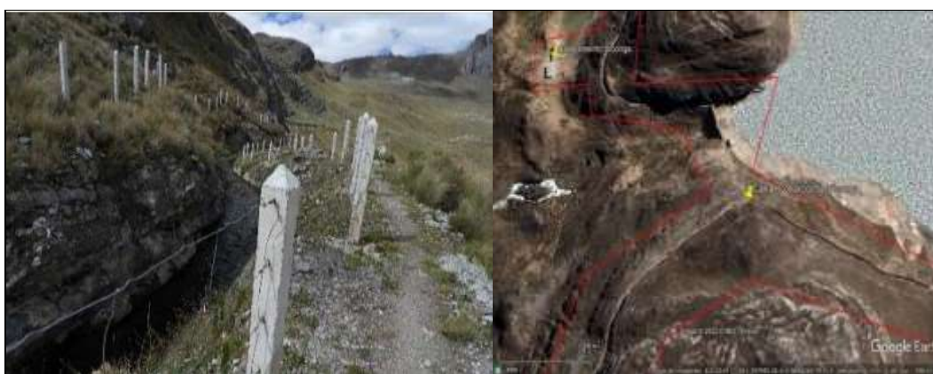
Imágenes 3 y 4. Componente principal Canal Collarcocha-Viconga, coordenadas UTM WGS 84, zona 18 L, 297 610 m E y 8 848 229 m S.
