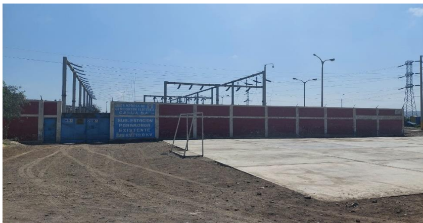
Fotografía 28. Subestación eléctrica Paramonga perteneciente a Statkraft. Se encuentra ubicada entre los asentamientos humanos Nueva Esperanza y La Unión. Fecha: 08/07/2022
