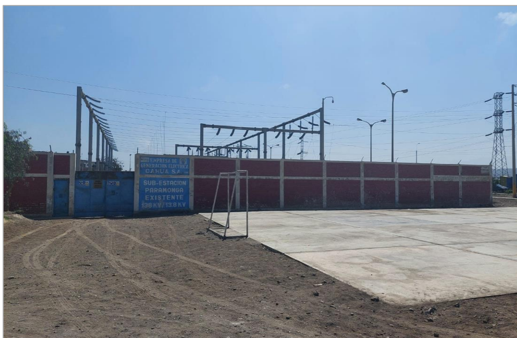
Fotografía 26. Vista de la subestación Eléctrica Paramonga perteneciente a Statkraft. Se encuentra ubicada entre los Asentamientos Humanos Nueva Esperanza y La Unión.
