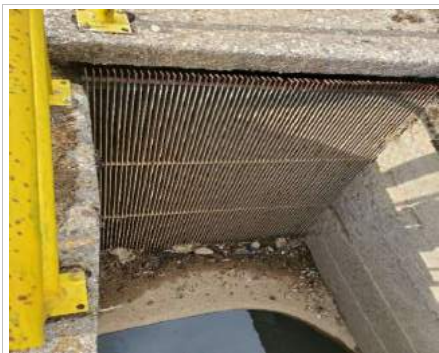
Figura 3.3 - 9 Rejilla fina del Desarenador
