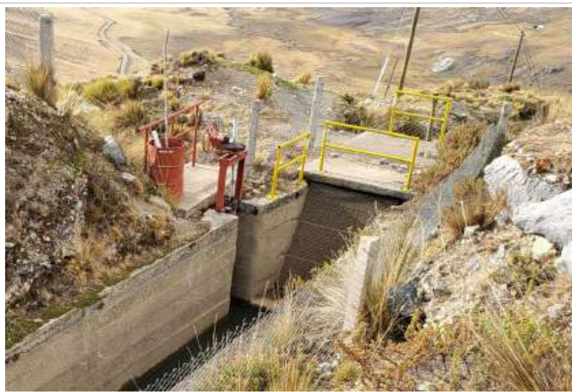
Figura 3.3 - 5 Cámara de carga
