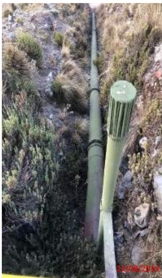
Componente Principal: Tubería forzada
