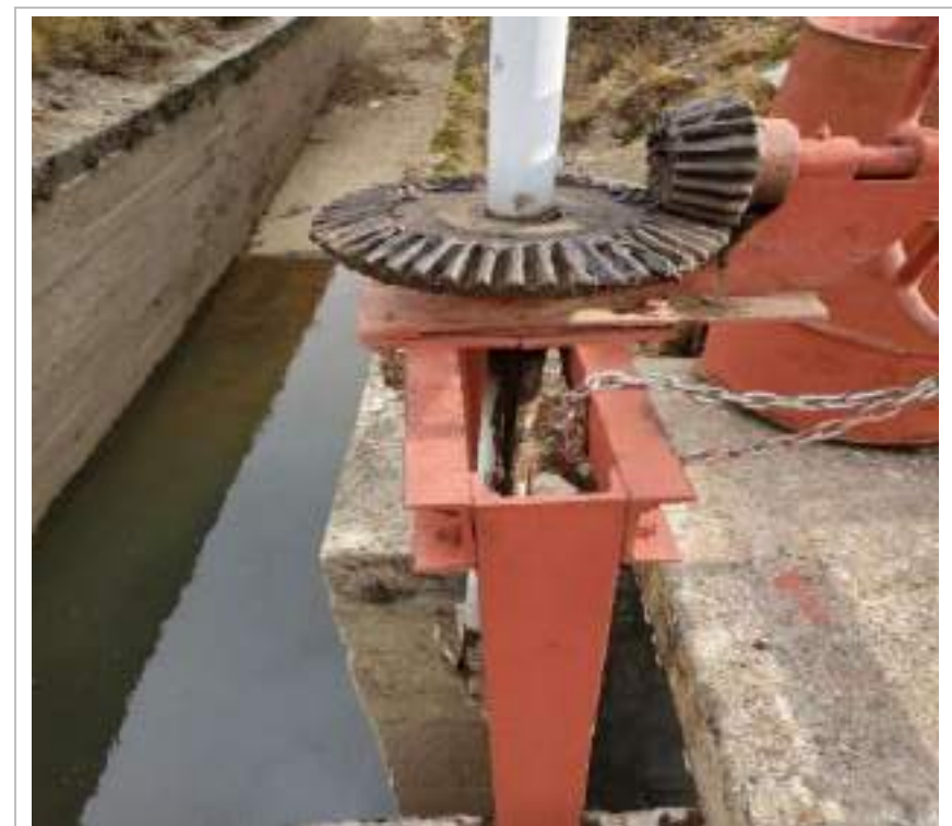
Figura 3.3 - 10 Compuerta de Regulación del Desarenador
