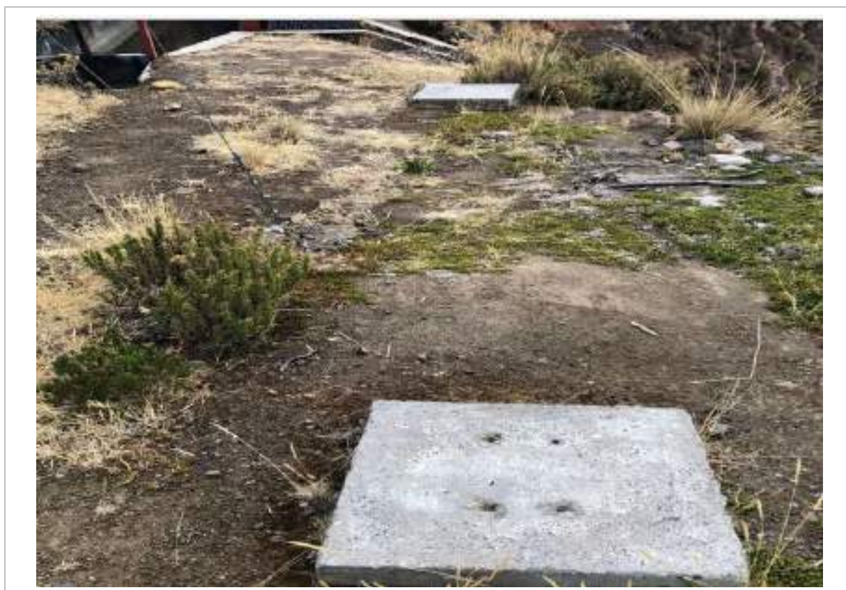
Figura 3.3 - 16 Pozo séptico 1 y 2
