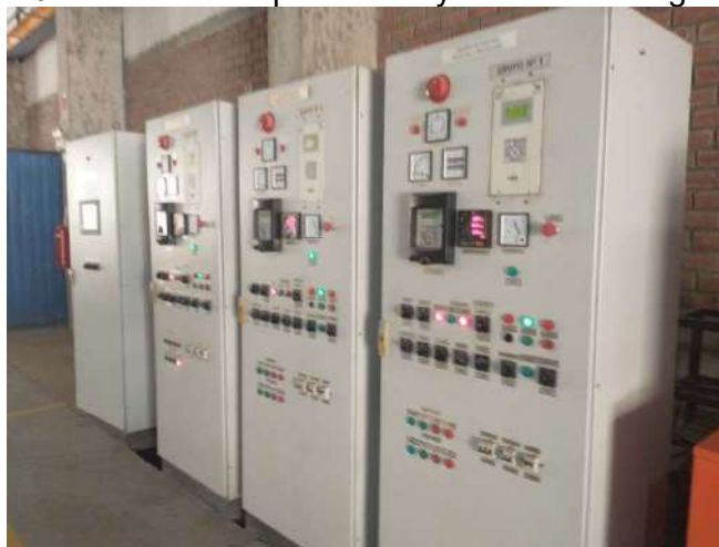
Figura N° 04: Tableros de protección y control de los generadores
