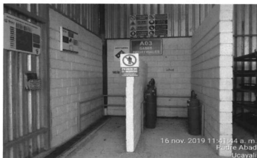
Almacén de Gases Comprimidos I Foto 4.2.3
