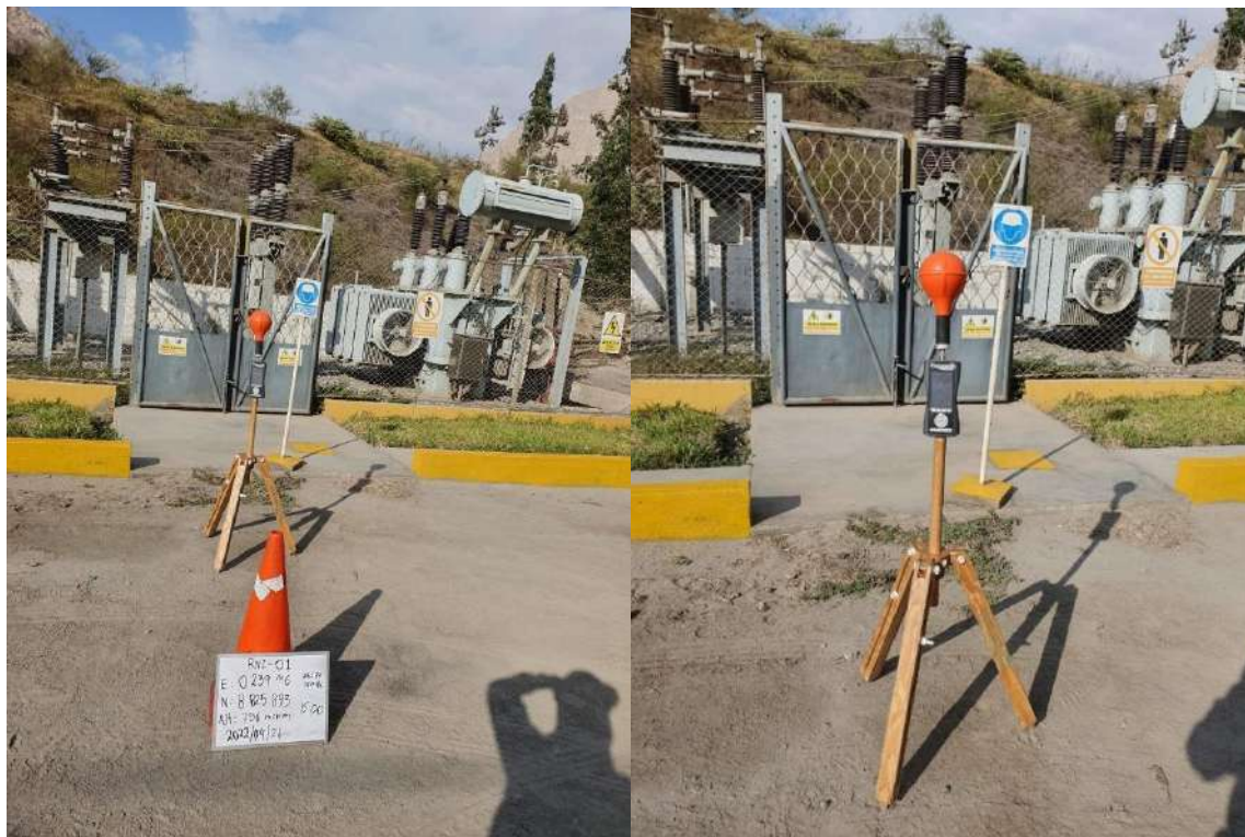
Fotografía 6.17. Fotografía de la medición de campo electromagnético RNI-01 - Ubicado a 3 m, parte frontal de la Subestación de Salida – Central Hidroeléctrica Yanapampa
