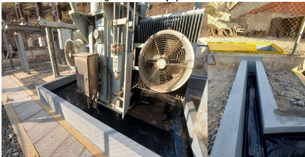
Fotografía 3.4. Bandeja y Canal de Evacuación
