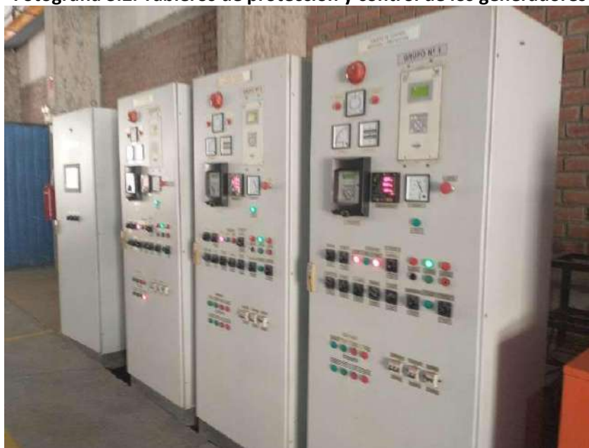
Fotografía 3.2. Tableros de protección y control de los generadores
