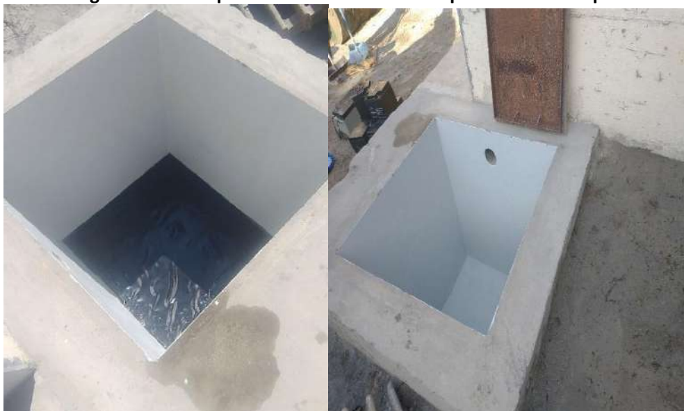
Fotografía 3.3. Tanque Colector de Contención para Residuos Líquidos
