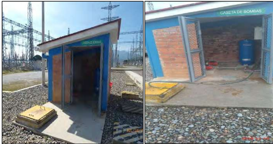
Figura 3.3.2.1- 5. Caseta de bombas
