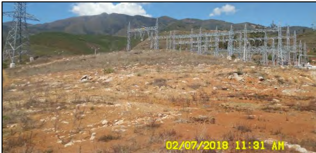
Imagen 1. Fotografía H01-6 del Informe de Supervisión. Vista de la Zona 1, en la cual se ha dispuesto material excedente producto de la construcción de la S.E. Cálclíc.
