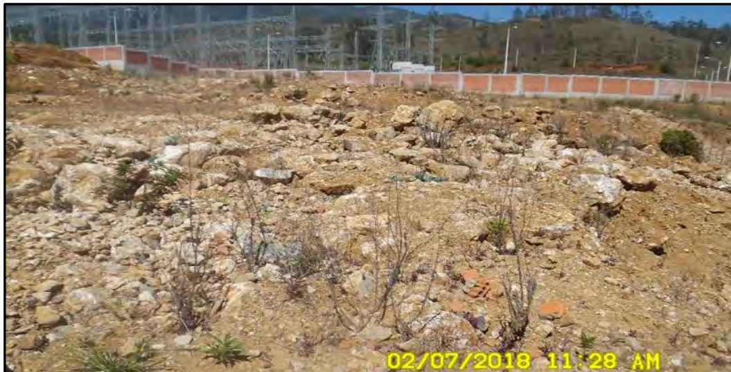
Imagen 2. Fotografía H01-10 del Informe de Supervisión. Vista de la Zona Nº2 en la cual se ha dispuesto material excedente producto de la construcción de la S.E. Cálclíc (material de excavación y material de construcción: ladrillos, plásticos, fierros, etc.)
