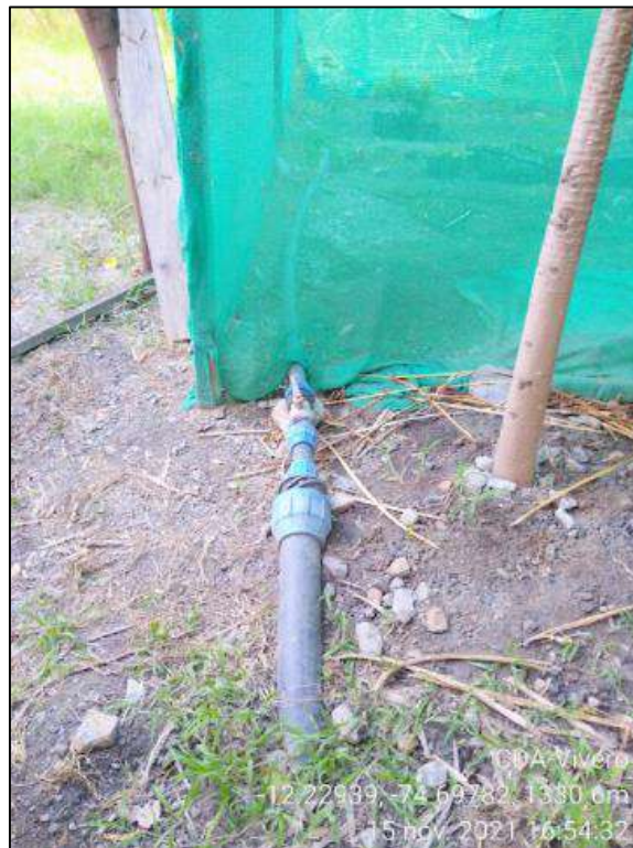
Figura 3.3.2-11. Manguera de Riego – Vivero Casa de Maquinas
