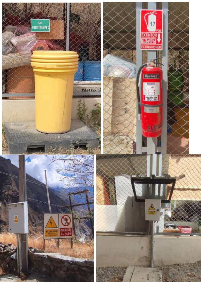
Figura 3.3.2-21. Instalaciones dentro del Almacén de Residuos Sólidos CDM
