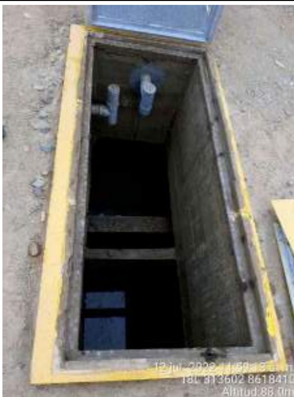
Fotografía N° 55: Interior de la poza colectora de los almacenes de materiales peligrosos de la C.T. Santo domingo de Los Olleros.
