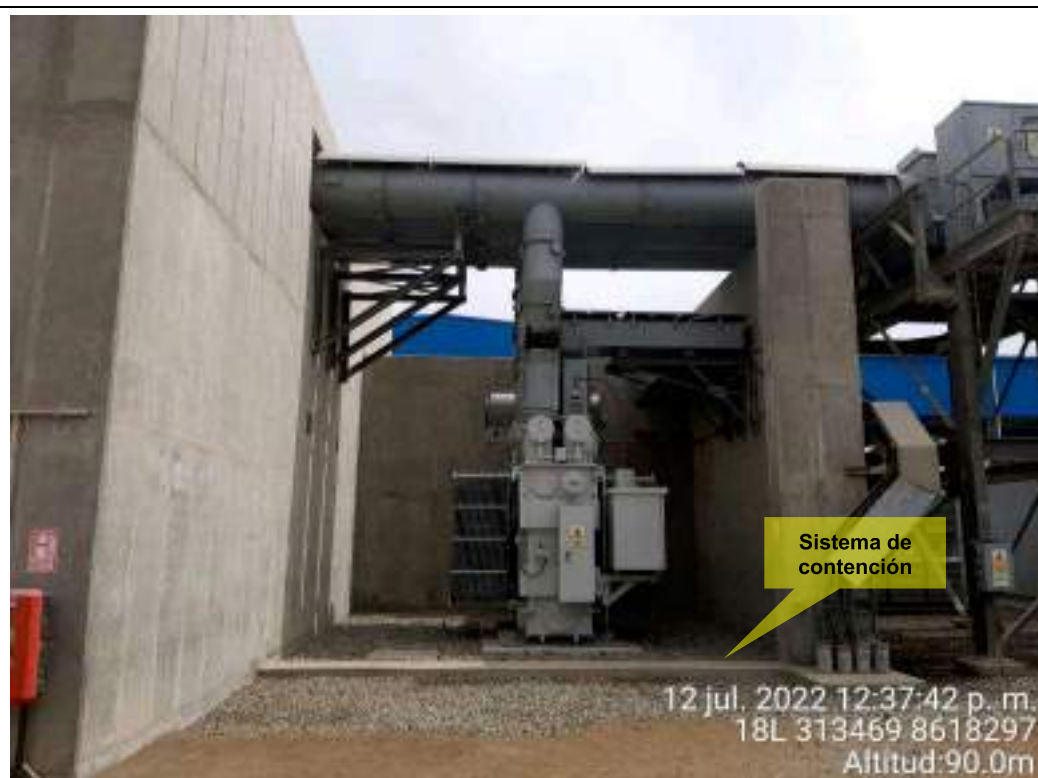
Fotografía N° 63: Transformador de Servicios Auxiliares sobre el sistema de contención de concreto.
