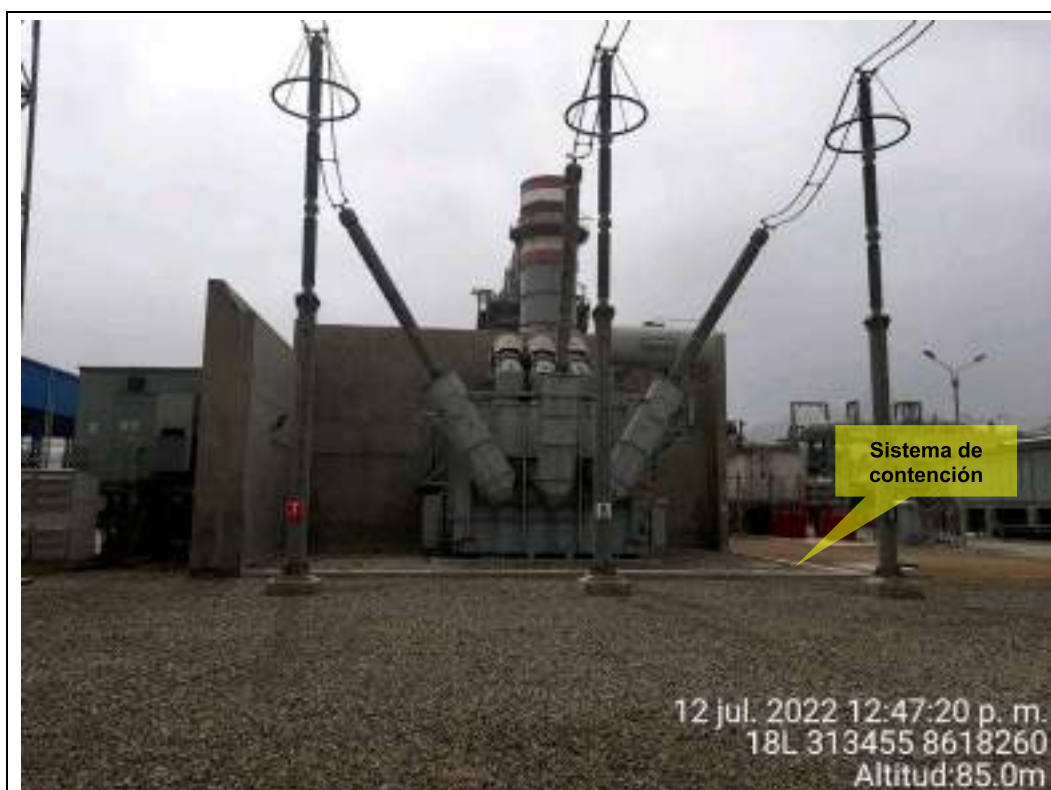
Fotografía N° 65: Transformador de la Turbina a Gas sobre el sistema de contención de concreto.
