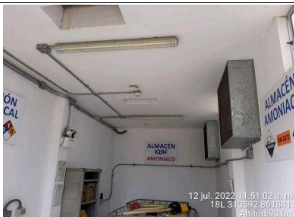
Fotografía N° 44: Interior del Almacén de Químicos Fiscalizados de la C.T. Santo Domingo de Los Olleros. Se observan los sistemas de admisión de aire forzado.
