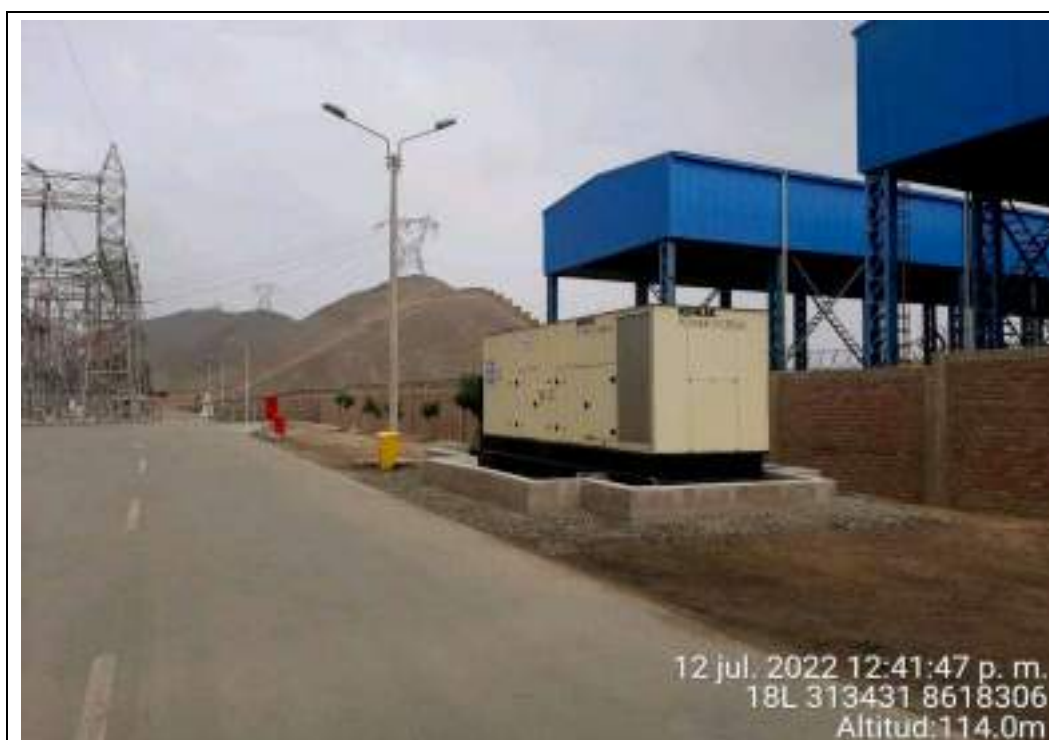
Fotografía N° 57: Grupo electrógeno de la C.T. Santo Domingo de Los Olleros. Se observa el grupo electrógeno encapsulado al interior de un sistema de contención de concreto impermeabilizado con pintura epóxica y berma de contención.
