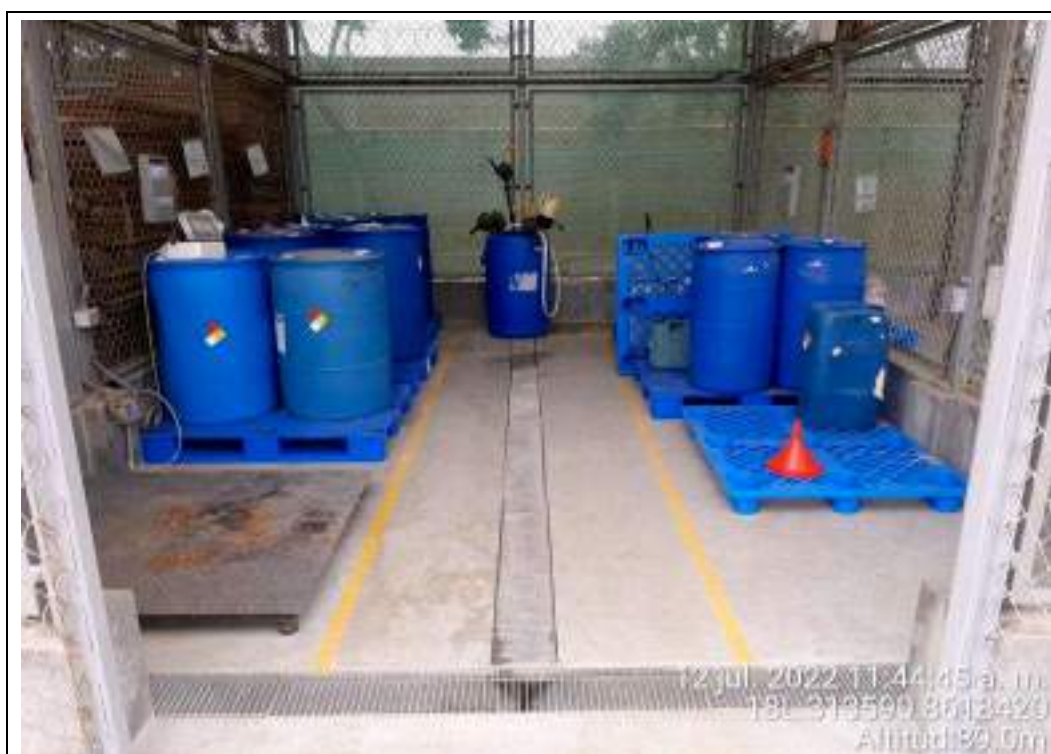
Fotografía N° 26: Interior del Almacén de Químicos No Fiscalizados 1 de la C.T. Santo Domingo de Los Olleros. Se observa drenaje perimetral e intermedio.
