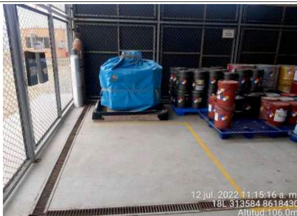
Fotografía N° 15: Interior del Almacén de Materiales Peligrosos de la C.T. Santo Domingo de Los Olleros. Se observa drenaje perimetral y transformador obre una bandeja recubierta con geomembrana.
