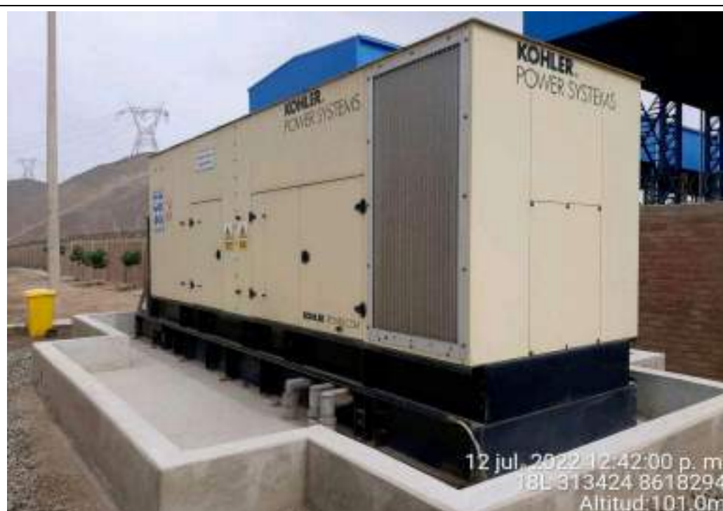
Fotografía N° 58: Grupo electrógeno de la C.T. Santo Domingo de Los Olleros. Se observa el grupo electrógeno encapsulado al interior de un sistema de contención de concreto impermeabilizado con pintura epóxica y berma de contención.
