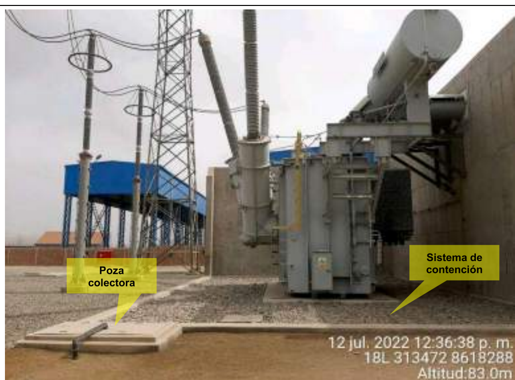
Fotografía N° 66: Transformador de la Turbina a Gas sobre el sistema de contención de concreto. Se señala la poza colectora de concreto.
