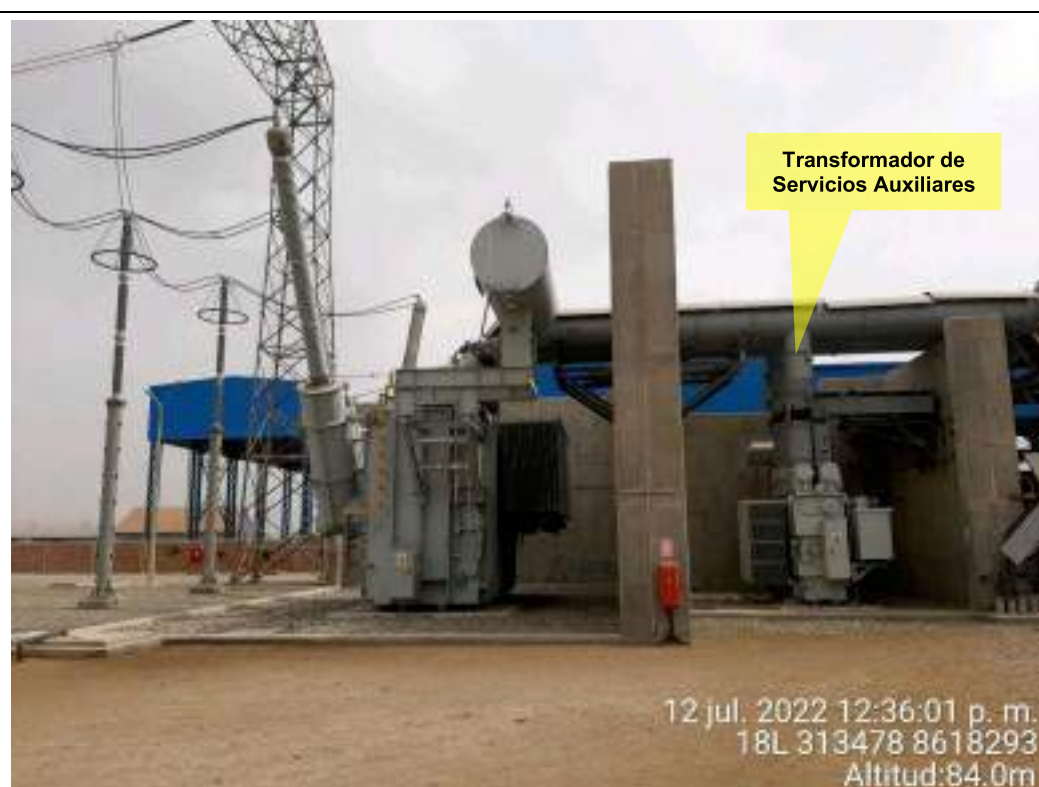
Fotografía N° 62: Transformador de Servicios Auxiliares.
