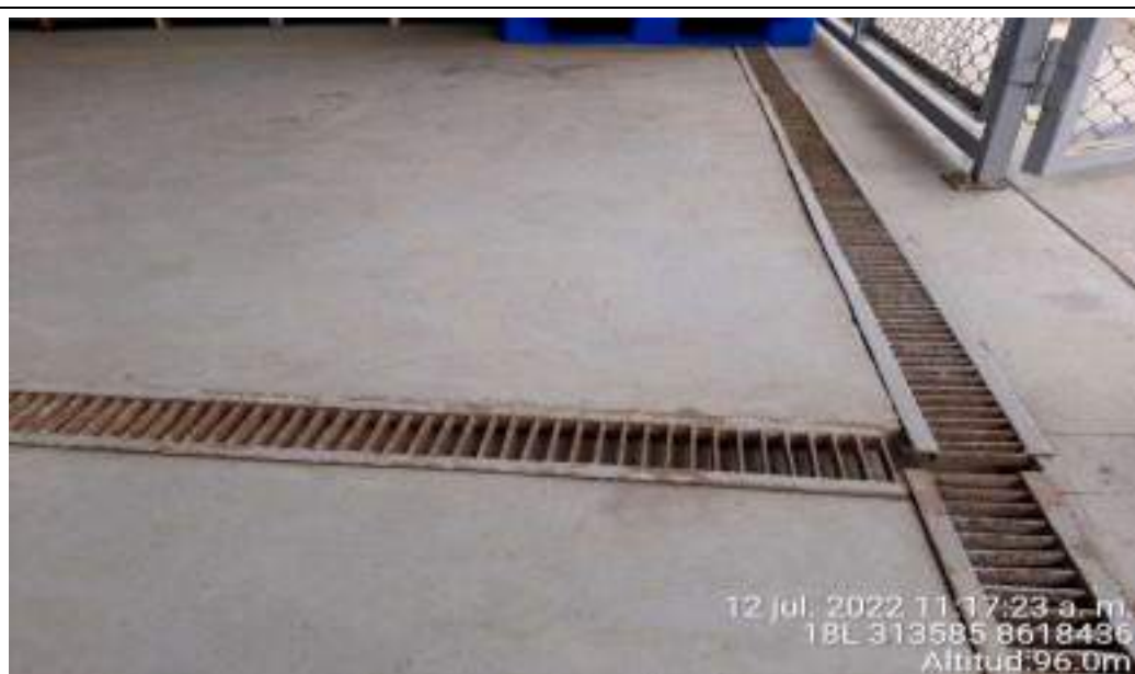
Fotografía N° 17: Drenaje perimetral al interior del Almacén de Materiales Peligrosos de la C.T. Santo Domingo de Los Olleros.
