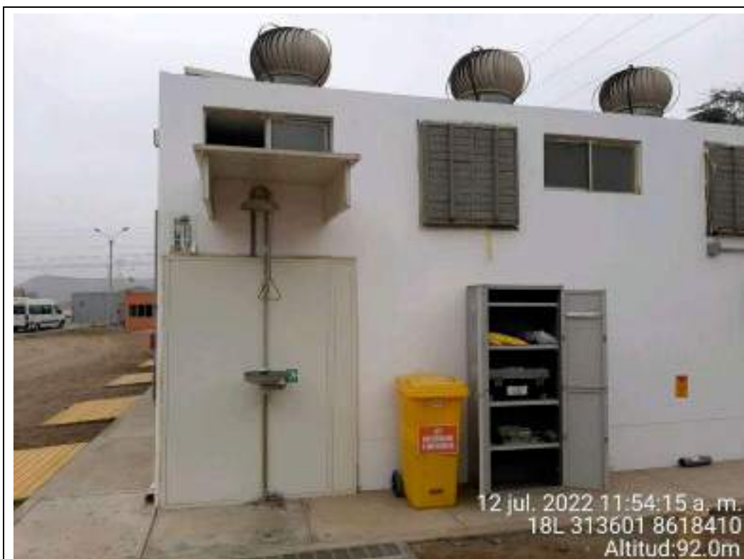
Fotografía N° 53: Sistema de higienización (ducha industrial y lavaojos), un (1) kit antiderrame y un (1) botiquín al exterior del Almacén de Químicos Fiscalizados de la C.T. Santo Domingo de Los Olleros.
