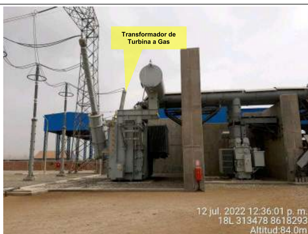
Fotografía N° 64: Transformador de Turbina a Gas.
