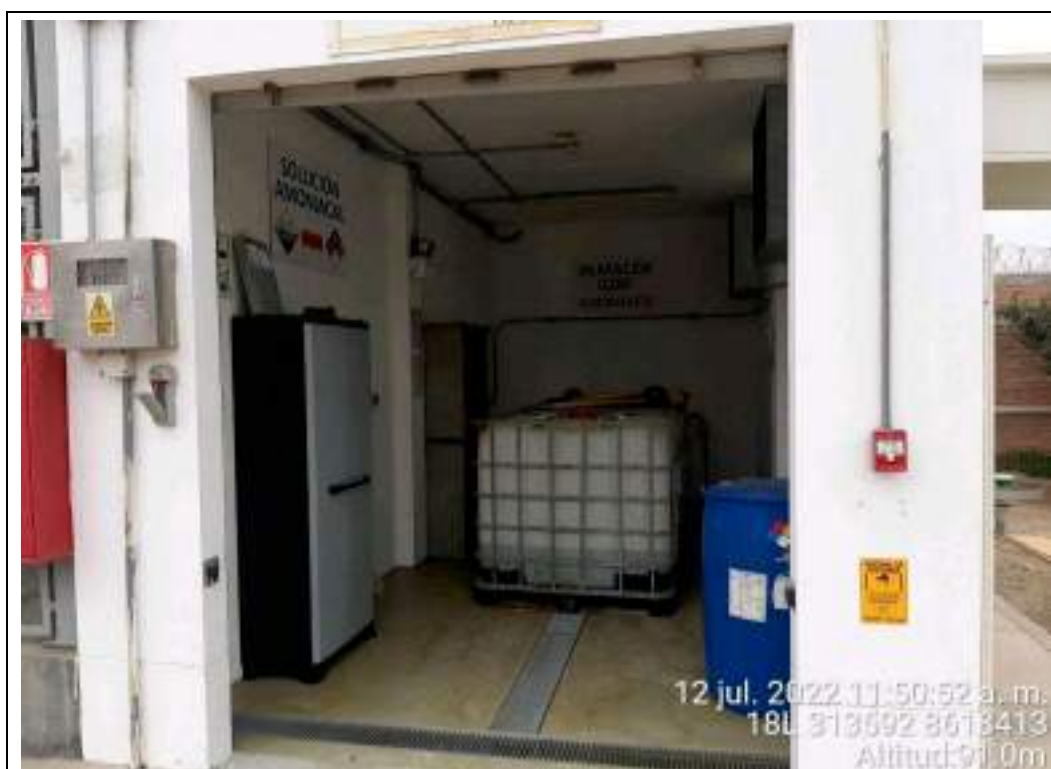
Fotografía N° 43: Almacén de Químicos Fiscalizados. Se observa sistema de alerta contra incendios.
