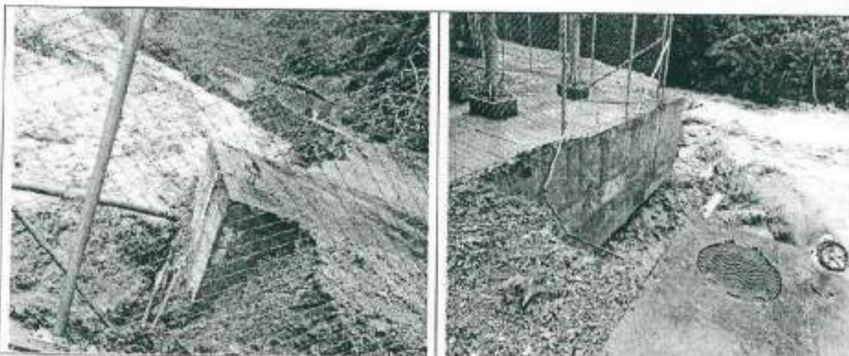
Figuras 10 y 11. Desmoronamiento del terreno Base TE03.
