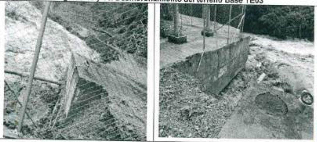
Figuras 10 y 11. Desmoronamiento del terreno Base TE03
