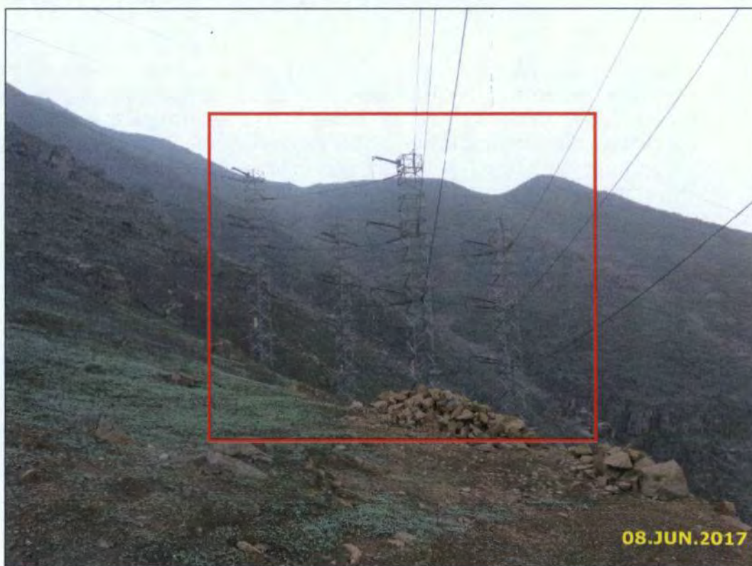
Foto 2. Vista de la estructura tipo pórtico de la L.T 220 kV S.E. Mirador - S.E. Malvinas instalada dentro de las Lomas de Amancaes.
