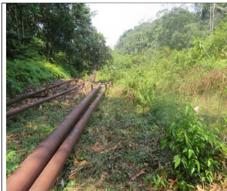
Foto 1. Sistema de tuberías asociadas a los pozos HUYS 13D, HUYS 12 D, HUYS 14 D (vista desde los pozos).
