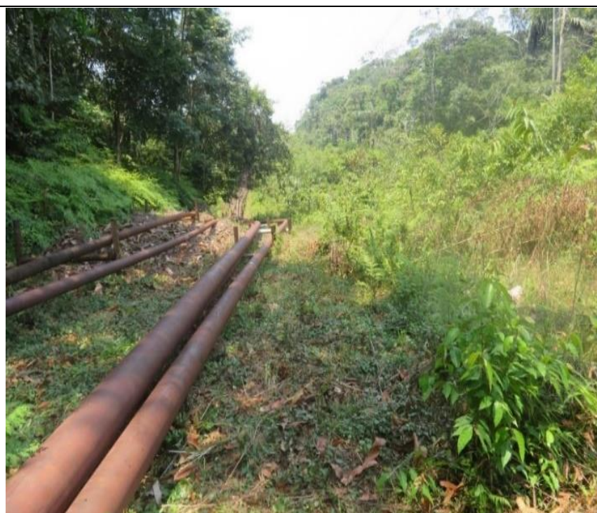
Foto 1. Sistema de tuberías asociadas a los pozos HUYS 13D, HUYS 12 D, HUYS 14 (vista desde los pozos).
