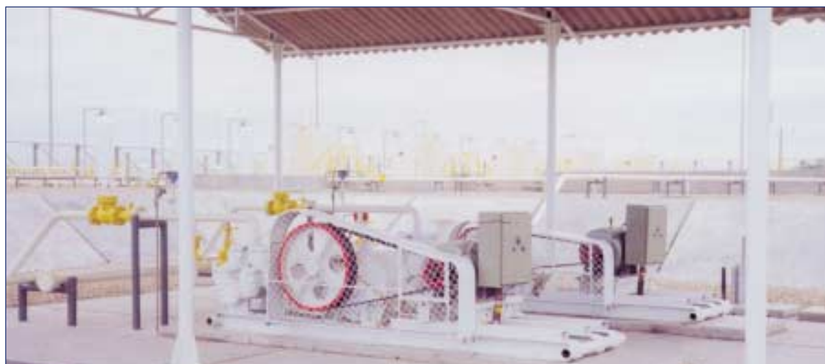
Sistema Bomba Motor en la Batería 951, Zapotal - Noroeste Pumping System Motor in 951 Zapotal Battery - Northwest
