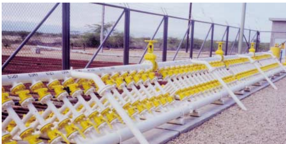
Manifold en la Batería 608, Carrizo - Noroeste Manifold in 608 Carrizo Battery - Northwest
