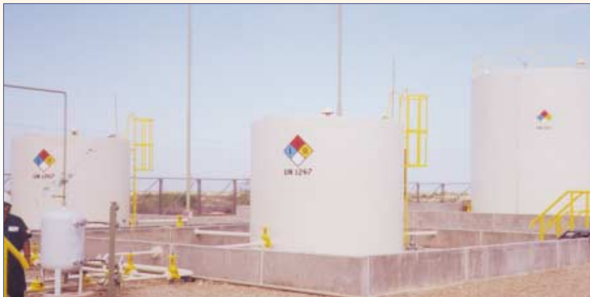
Tanques de Almacenamiento de la Batería 608, Carrizo - Noroeste Storage Tanks of 608 Carrizo Battery – Northwest
