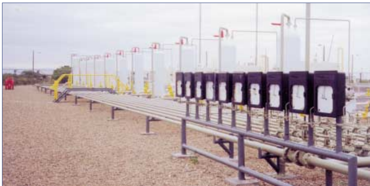
Medidores de Gas y Separadores en la Batería 951, Zapotal - Noroeste Gas Meters and Separators with 951 Zapotal Battery - Northwest
