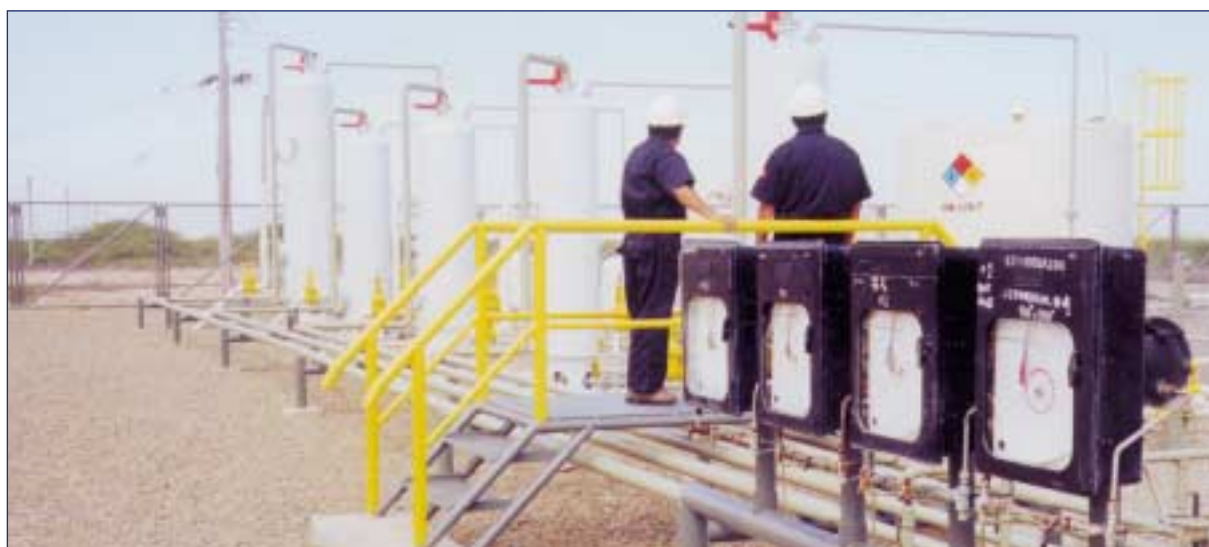
Medidores de Gas y Separadores en la Batería 608, Carrizo - Noroeste Gas Meters and Separators in 608 Carrizo Battery - Northwest
