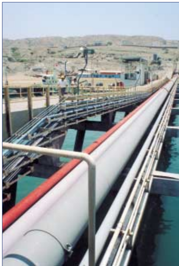
Sistema de Tuberías para Carga y Descarga de Productos - Noroeste Pipeline System for Product Loading and Unloading - Northwest
