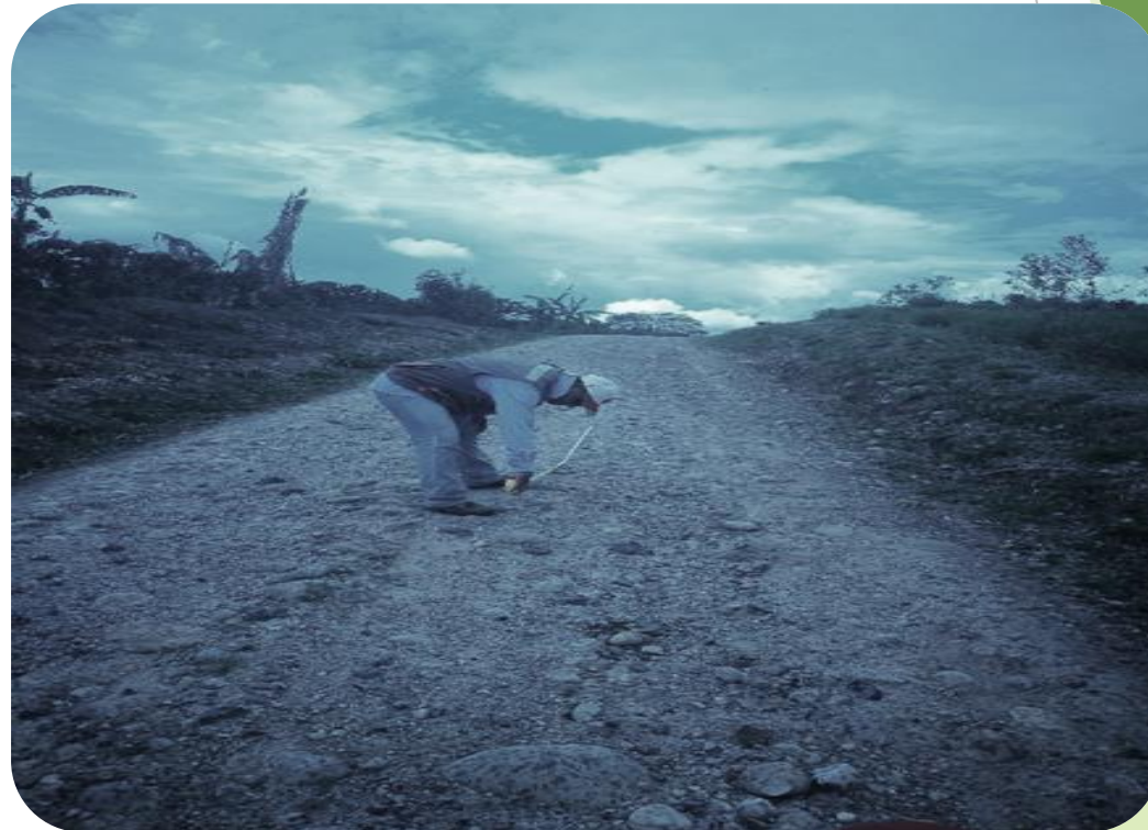
Medición de la profundidad del bache en la plataforma de la vía.
