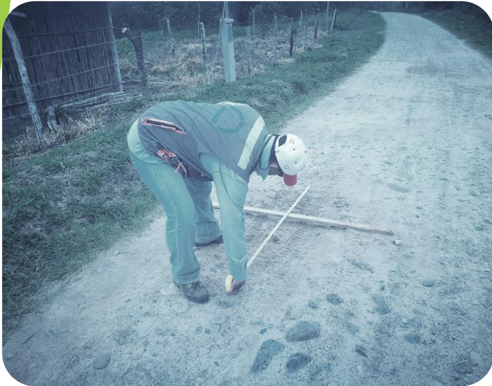
Medición de un Bache en la plataforma de la vía.
