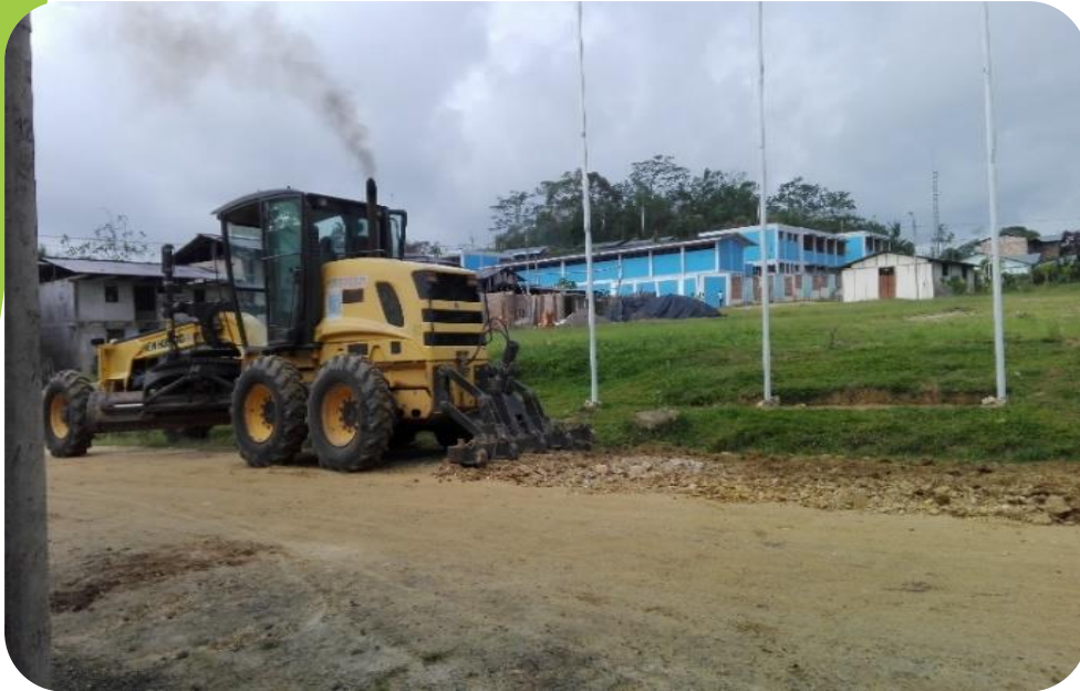
Vista 1: Se realiza primero el Escarificado y corte del Afirmado Granular Existente
