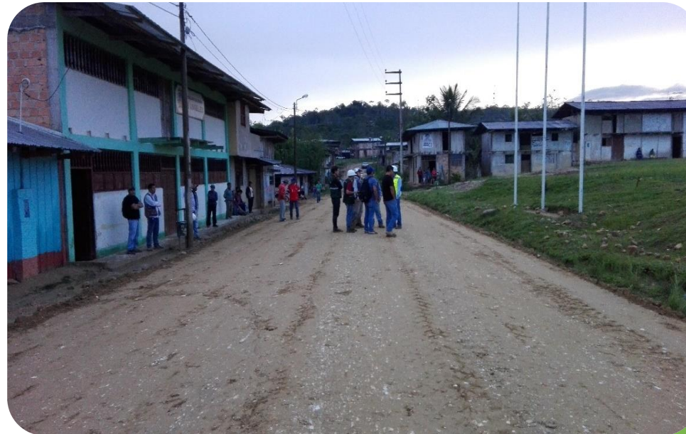
Vista 9: Se continua con el proceso de mezclado y el perfilado de la superficie
