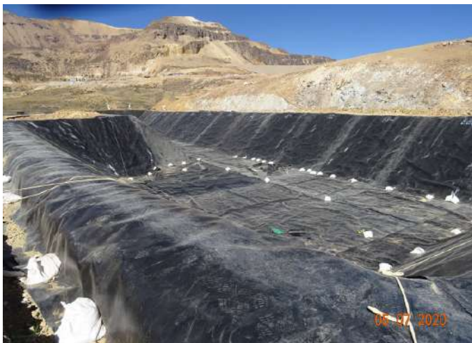
Fotografía 8: Vista de la Poza de 5000 m3 revestida con material de geomembrana.
