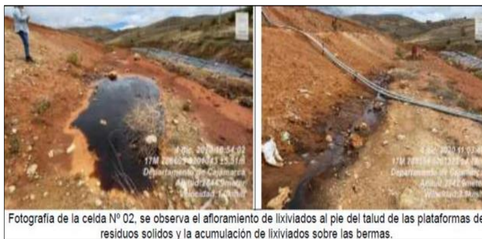
Imagen N° 11 Plataformas de la celda N° 02 Afloramiento de lixiviados
