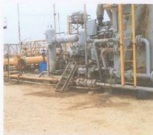
Foto N° 11 (AIH-5) Área impregnada con aceite ubicada en zona adyacente al compresor RV-4220 de la Estación de Compresores. Coordenadas UTM – WGS 84: 485860E, 9456315N.
