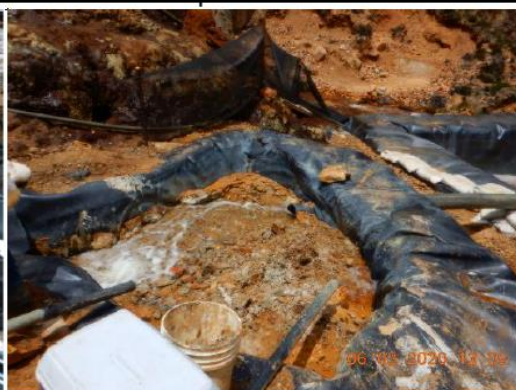
Fotografía 156. IMG_6471: Vista de la limpieza de la poza sedimentadora, logrando recuperar el curso posterior a la poza de colección, con la presencia todavía de sedimentos.
