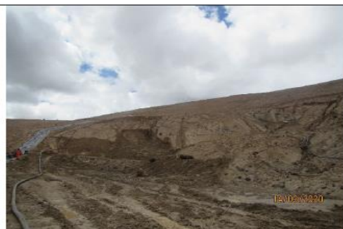
Fotografía 11: Tubería de salida de la poza de sedimentación para conducción de los afloramientos N° 2 y N° 3 hacia la PTAA DD N° 1. Fuente: Supervisión 26.02.22-15.03.22
