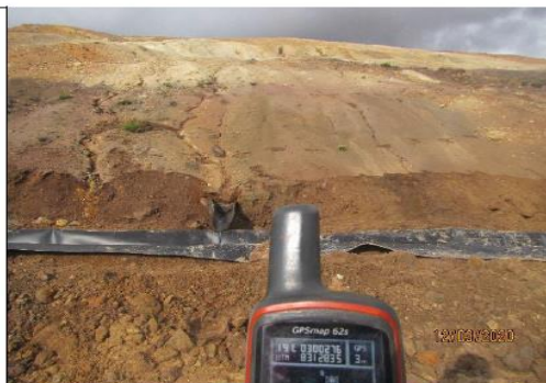
Fotografía 6: Captación de los afloramientos N° 2 y 3 mediante un canal hacia una piza y de esta conducido a por una tubería a la PTAA DD N° 1. Fuente: Supervisión 26.02.22-15.03.22
