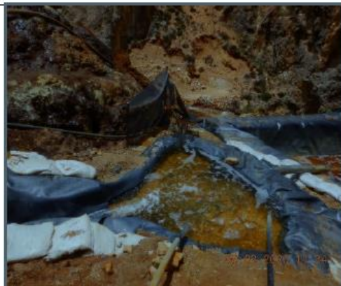
Fotografía 1: Fuga de agua detectada el 06-03-2022 Fuente: Anexo 8 – Acta de Supervisión 26.02.20-15.03.20
