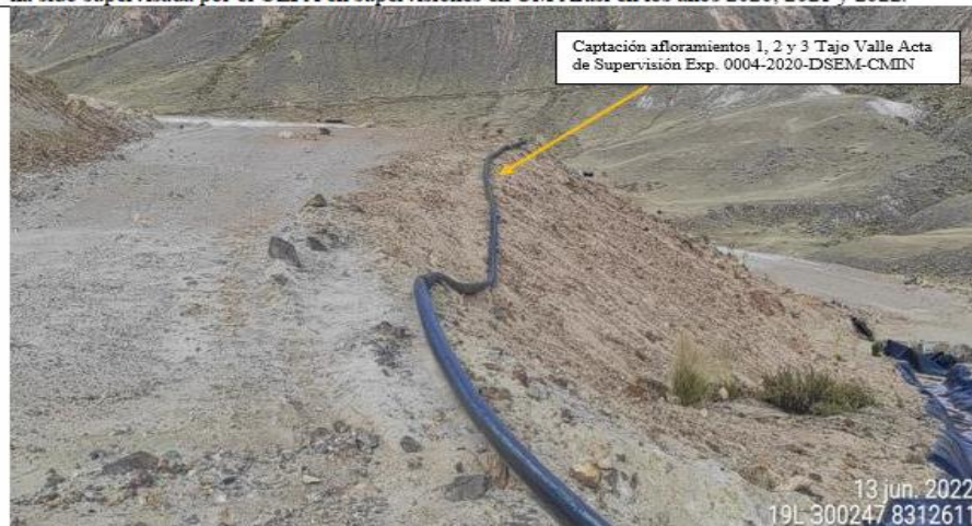
Fotografía 13: Tubería de conducción de los afloramientos N° 1, 2 y 3 hacia la PTAA DD N° 1, la cual ha sido supervisada por el OEFA en supervisiones en UM Arasi en los años 2020, 2021 y 2022.
