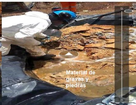
Fotografía 154. Correspondiente al video IMG_20200306_113939: Vista de la limpieza de la poza sedimentadora, la misma que permite ver material de gravas, piedras y los sedimentos que saturan la poza.
