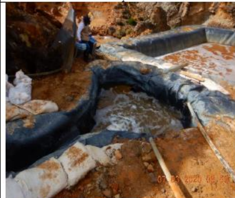
Fotografía 4: Verificación de la poza por parte de los supervisores del OEFA, la cual se encuentra sin sedimentos en su interior Fuente: Anexo 8 – Acta de Supervisión 26.02.20-15.03.20
