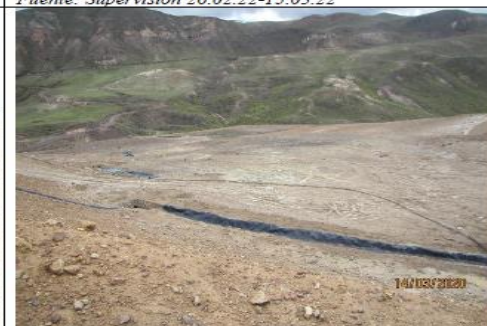
Fotografía 12: Tubería de salida de la poza de sedimentación para conducción de los afloramientos N° 2 y N° 3 hacia la PTAA DD N° 1. Fuente: Supervisión 26.02.22-15.03.22
