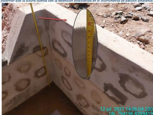
Fotografía N° 32: Vista de la medición de la sección de la caja colectora N° 4, en el cual se puede observar que la altura cuenta con la extensión establecida en el instrumento de gestión ambiental.
