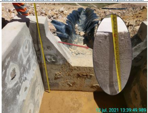
Fotografía N° 36: Vista de la medición de la sección de la caja colectora N° 6, en el cual se puede observar que la altura cuenta con la extensión establecida en el instrumento de gestión ambiental.
