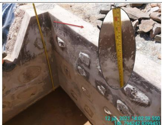
Fotografía N° 34: Vista de la medición de la sección de la caja colectora N° 5, en el cual se puede observar que la altura cuenta con la extensión establecida en el instrumento de gestión ambiental.
