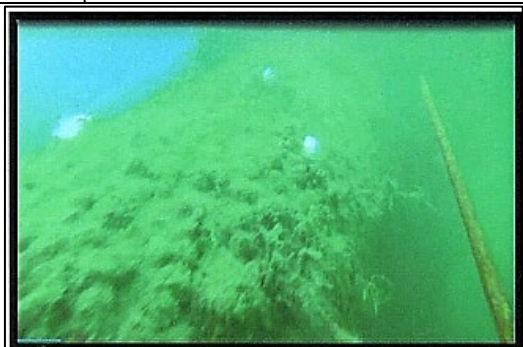
Foto N° 5. Vista del emisario submarino en el fondo del mar y del muerto o anclaje.
