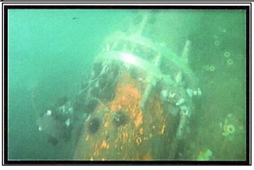
Foto N°4. Vista del emisario submarino en el fondo del mar.
