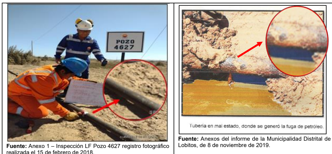
Cuadro N° 16: Registro fotográfico del estado de la tubería
