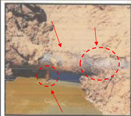
Tubería en mal estado, donde se generó la fuga de petróleo.
