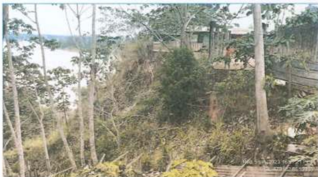
Foto 6: Viviendas expuestas en la cárcava costanera norte
