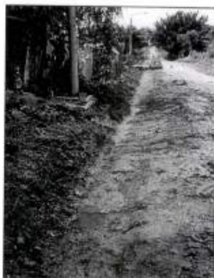
Imagen N° 09: Excavación con maquinaria irregular.
