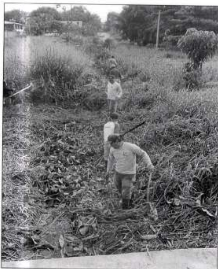
IMAGEN N05: Cultivo de maleza antes de la limpieza del caño natural y/o dren pluvial
