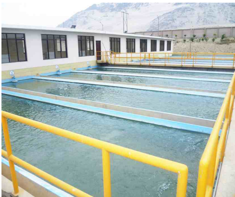
Planta de Tratamiento de Agua Potable PTAP
