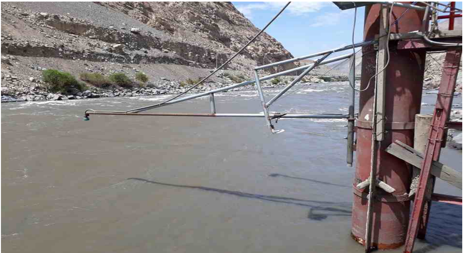
Labores de mantenimiento en sensor de caudal del río Santa del Proyecto CHAVIMOCHIC
