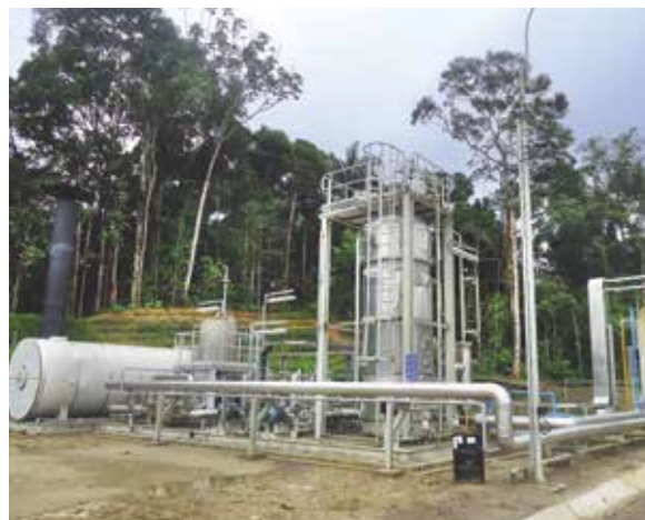
Tratamiento de petróleo, Lote 67 (Selva). Foto GFHL-Osinergmin.
