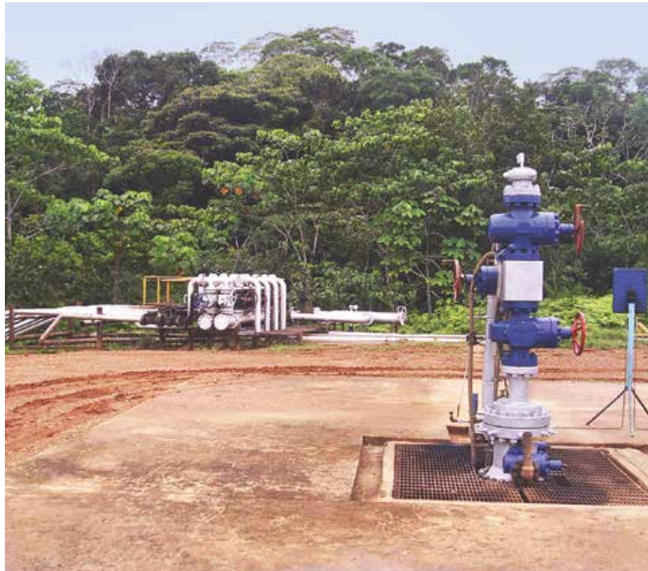
Múltiple de distribución forestal (Selva). Foto GFHL-Osinergmin.
