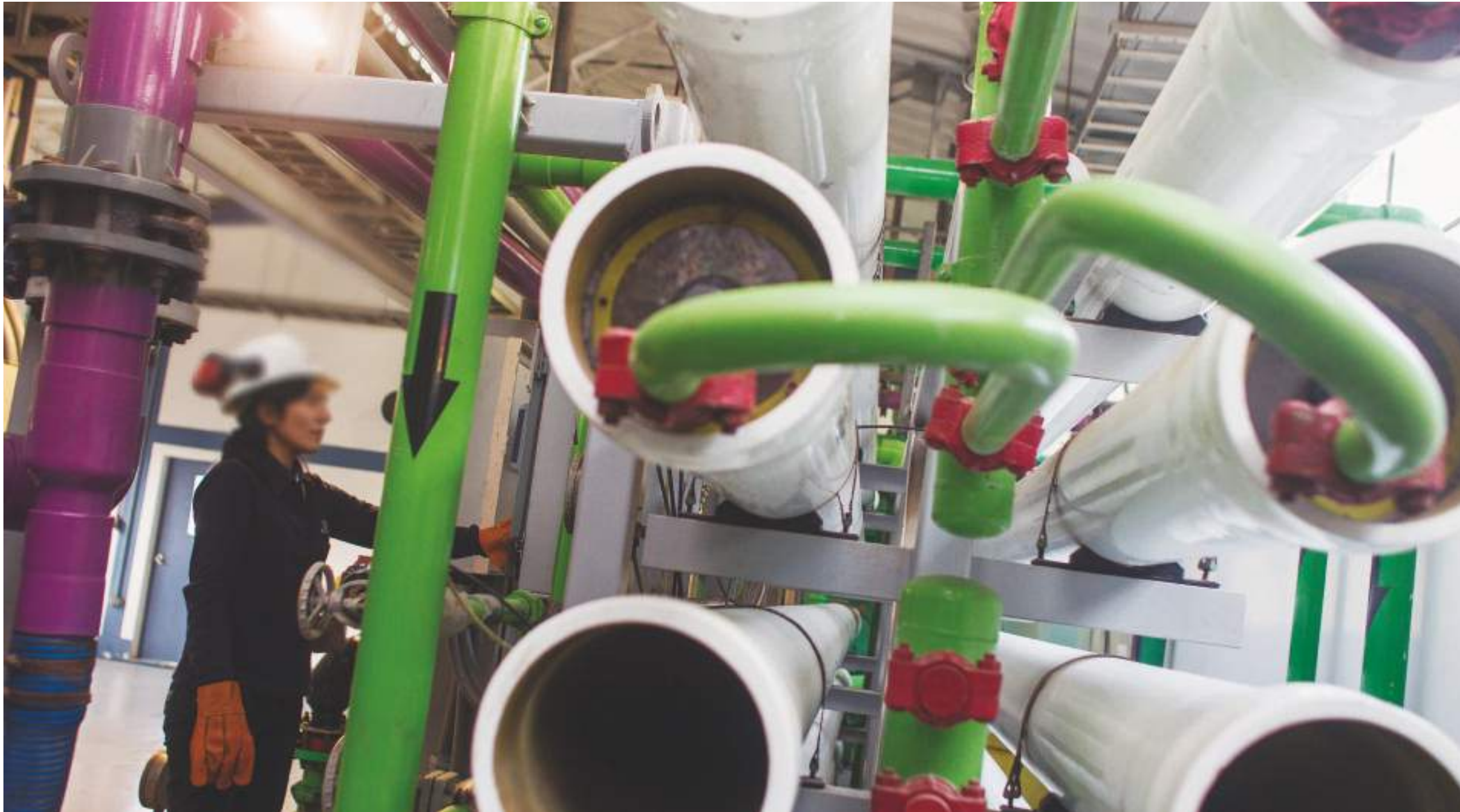
Foto: Central termoeléctrica de Ventanilla, Lima-Perú.
