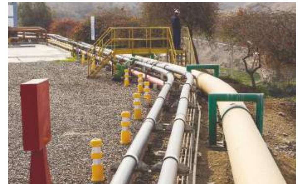
Foto: Central termoeléctrica de Ventanilla, Lima-Perú.
