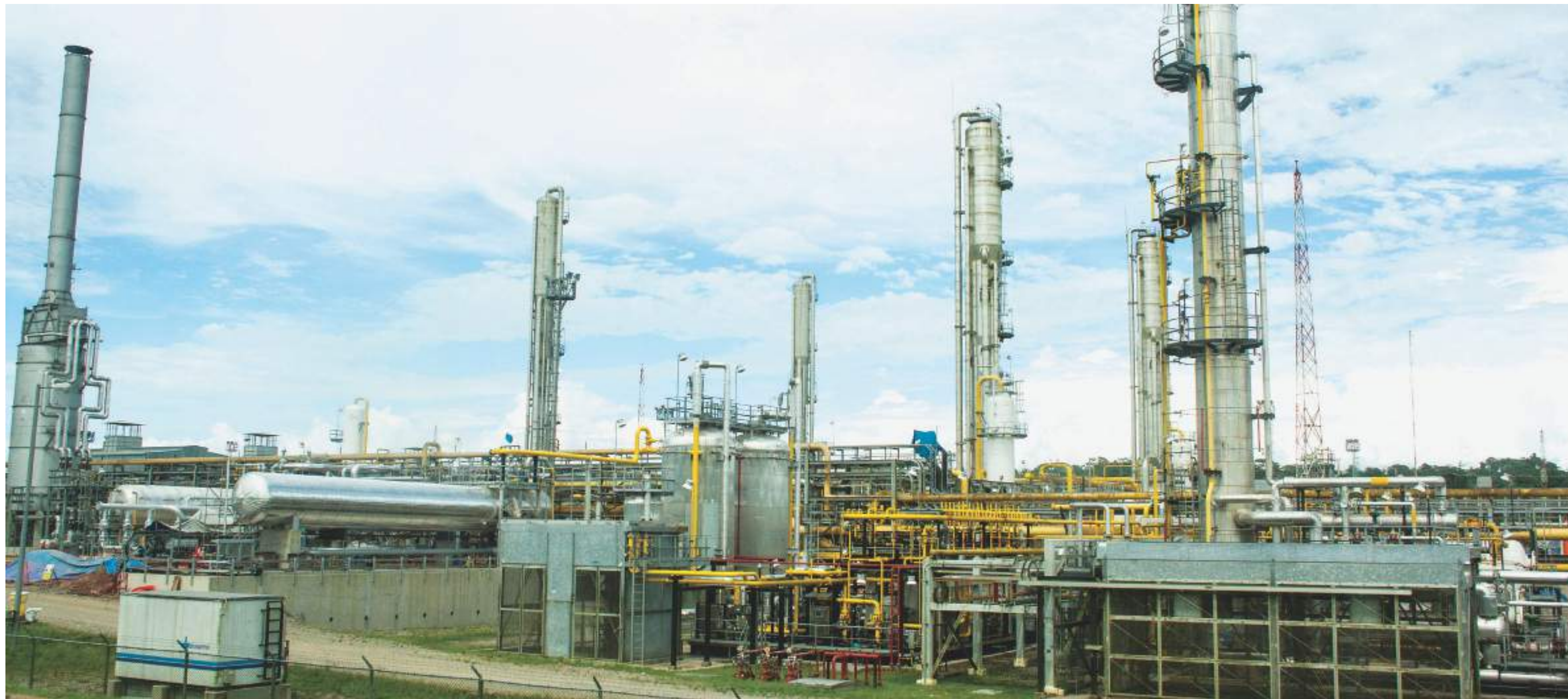
Foto: Planta de separación de gas natural Malvinas, Cusco-Perú.
