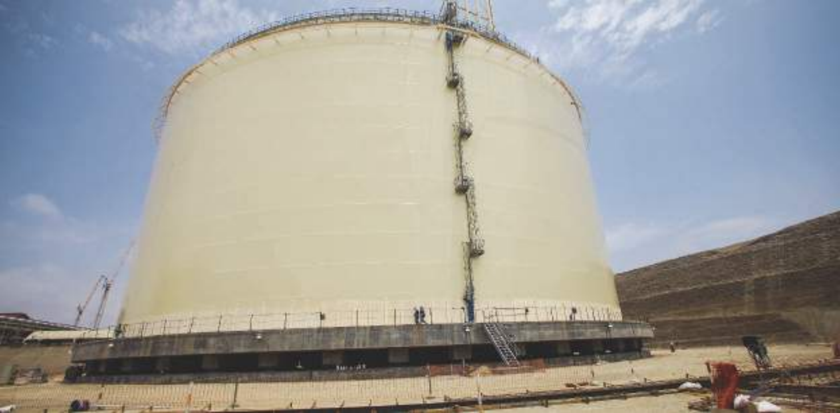
Foto: Planta de licuefacción de gas natural Pampa Melchorita, Lima-Perú.
