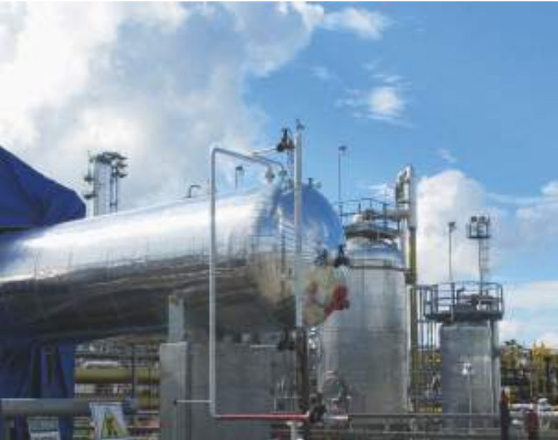
Foto: Planta de separación de gas natural Malvinas, Cusco-Perú.
