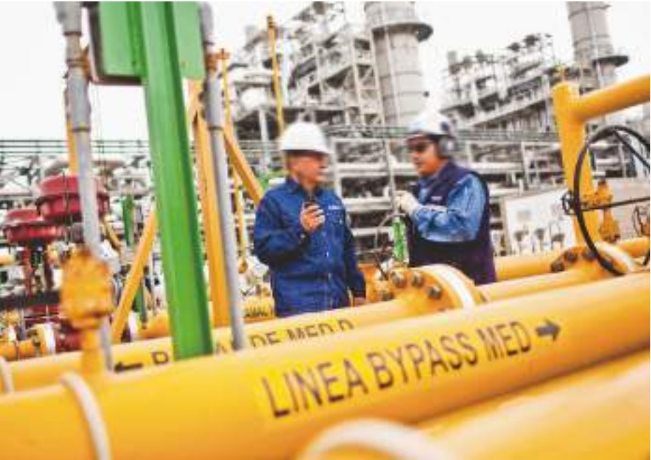
Instalaciones de la planta termoelectrica Chilca, departamento de Lima.
