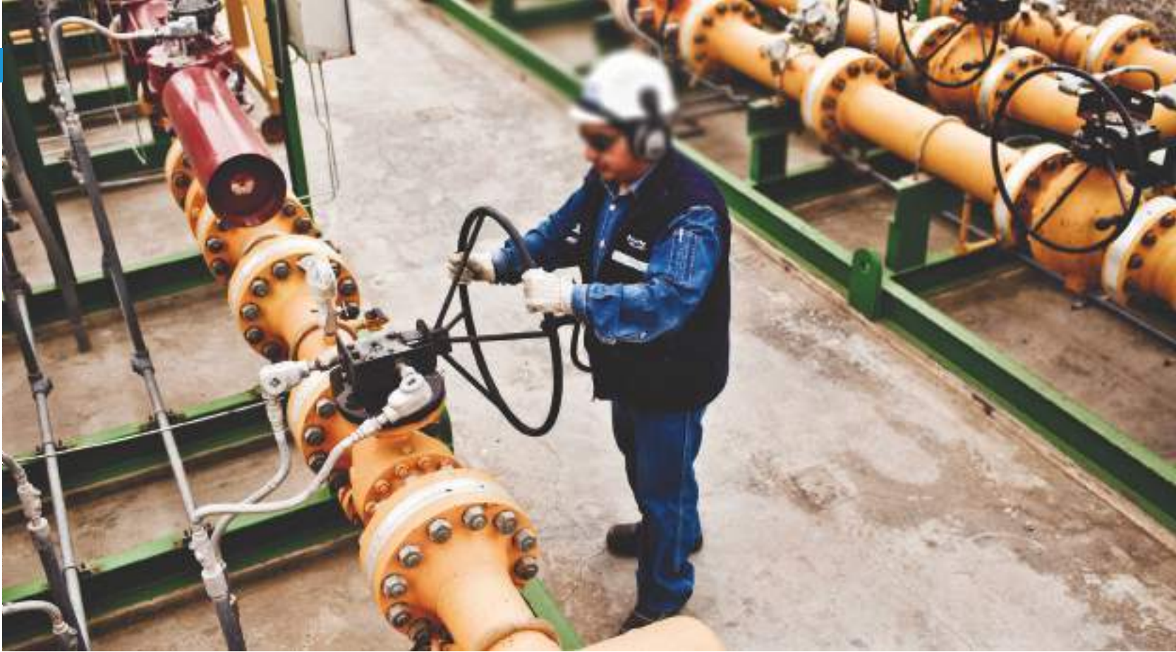
Foto: Instalaciones de la planta termoelectrica Chilca, Lima-Perú.
