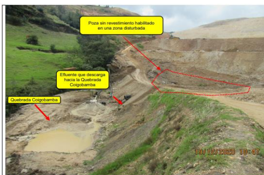
Fotografía 80. Vista de la descarga del efluente proveniente de la poza sin revestimiento 254 .
