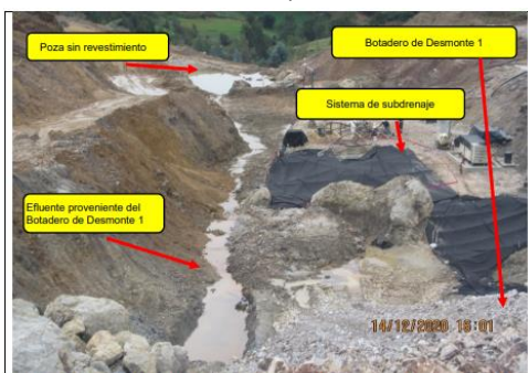
Fotografía 51. Vista del pie del Botadero de Desmonte 1, se observa que el efluente discurre por el canal habilitado en el suelo en una distancia aproximada de 120 metros hacia una poza sin revestimiento 198 .
