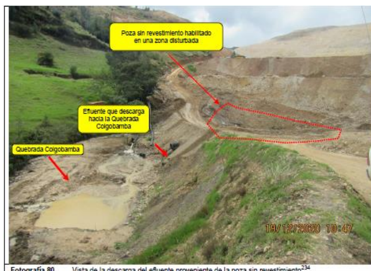
Fotografía 80. Vista de la descarga del efluente proveniente de la poza sin revestimiento 234
