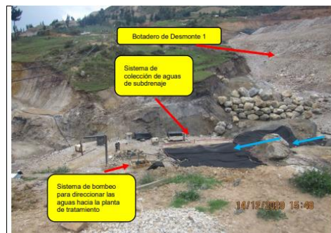
Fotografía 44. Vista del sistema de aguas de subdrenaje del Botadero de Desmonte 1, las aguas son captadas y enviadas a la planta de tratamiento de aguas ácidas para su tratamiento 192 .
