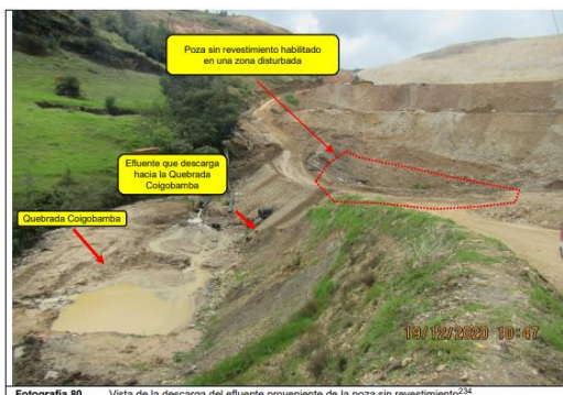
Fotografía 80. Vista de la descarga del efluente proveniente de la poza sin revestimiento 244 .
