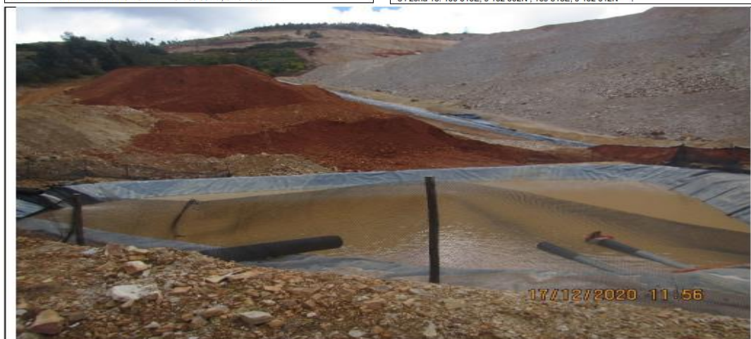
Fotografía 90. Vista de la poza revestida con geomembrana donde ingresa el agua de la quebrada Colgobamba ubicada en las coordenadas UTM WGS 84 zona 18: 169 167E, 9 131 814N 253 .
