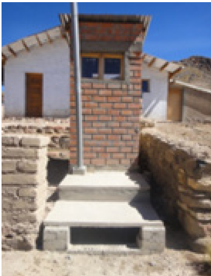
Fig.12 Núcleo sanitario de cocina y cubeta
