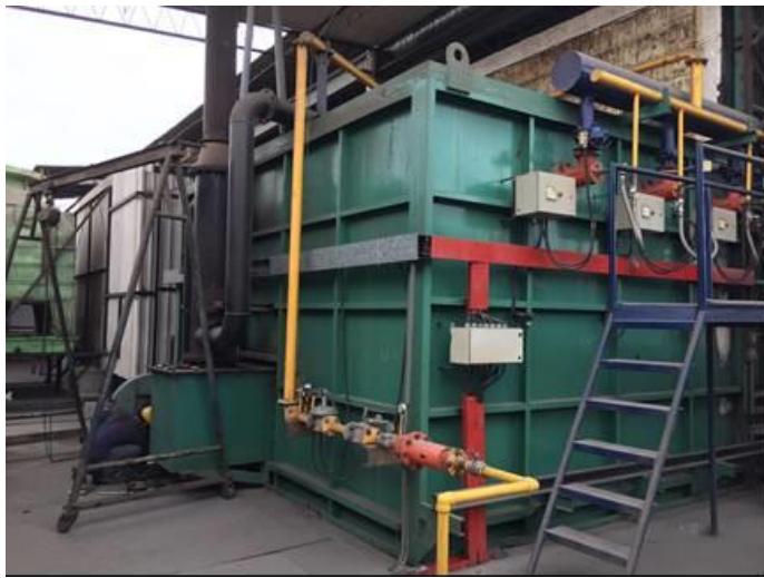
Figura 19. Horno 7 con precalentador de aire, quemadores pulsantes y control SCADA.
