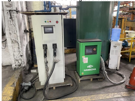
Figura 24. Estación de carga de baterías
