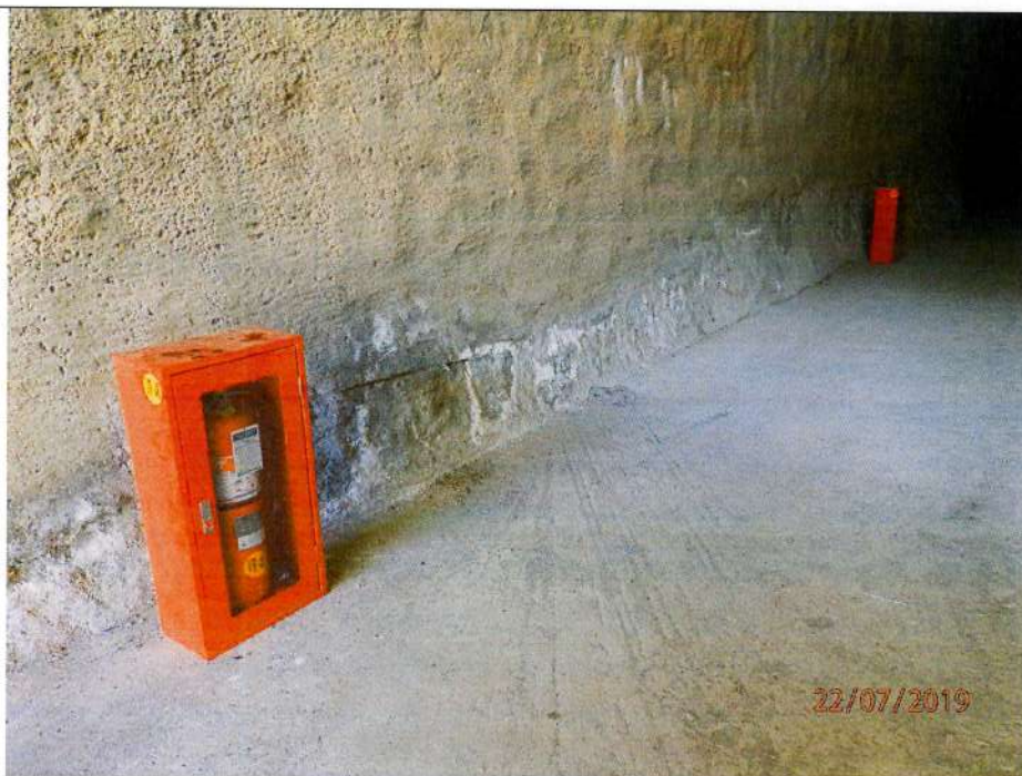
Fotografía N° 13: vista del interior del almacén temporal de residuos sólidos peligrosos, en la cual se puede observar dos (02) extintores para ser utilizados en caso de emergencias.
