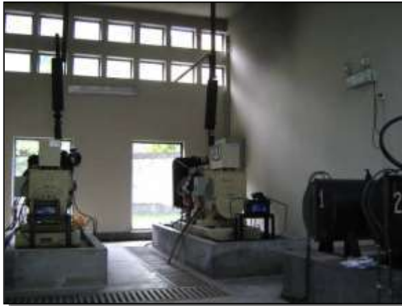
Grupo generador: Villa Residentes
