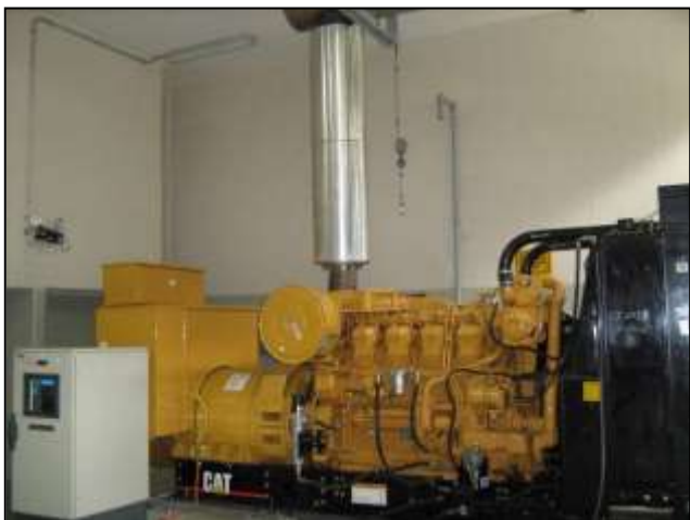
Grupo generador: Subestación
