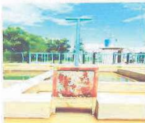
Imagen N° 78: Compuertas en mal estado
