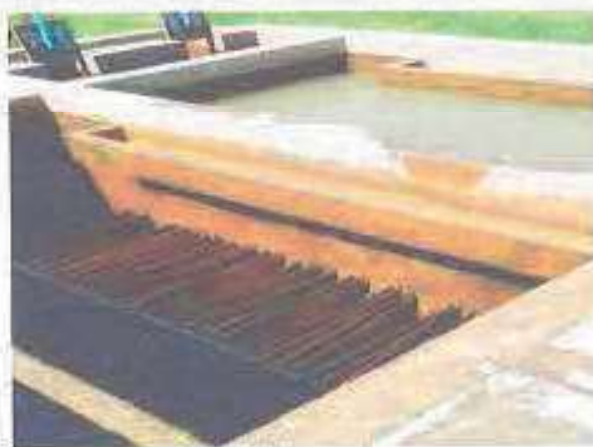
Imagen N° 79: Vista de decantadores deficientes
