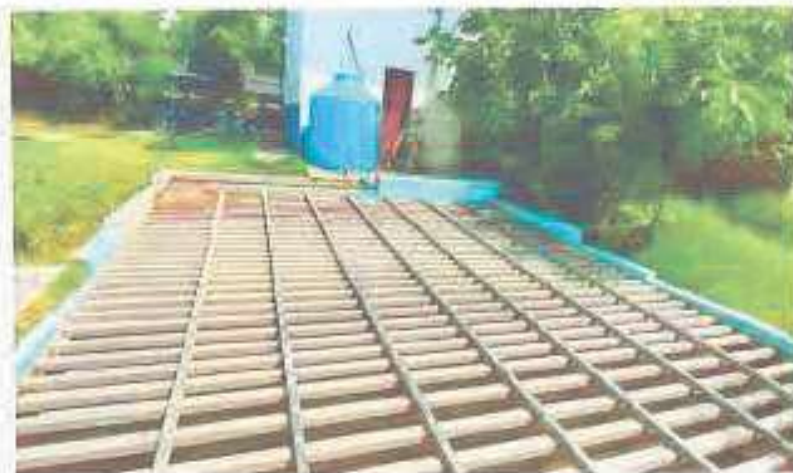
Imagen N° 77: Vista de los floculadores horizontales
