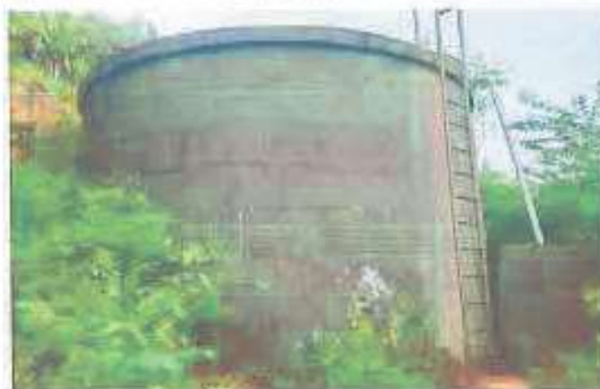
Imagen N° 83: Reservorios de 80 m3 y caseta de válvulas
