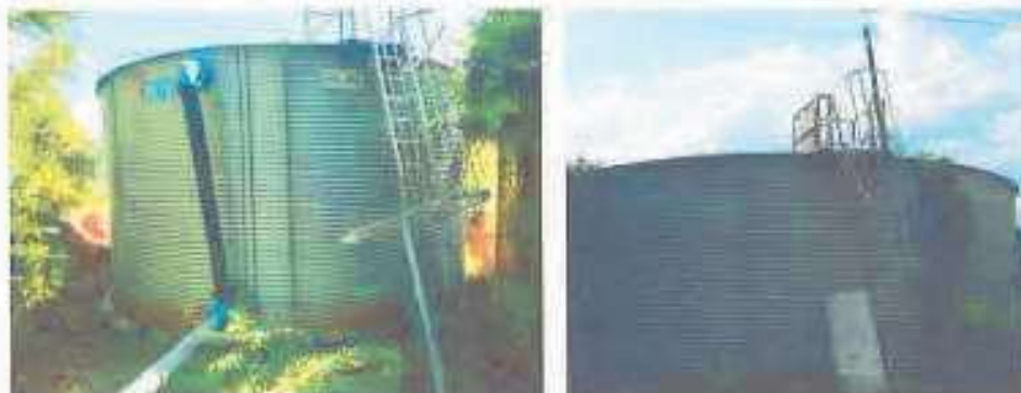
Imagen N° 86: Reservorios de 250 m 3 portátiles
