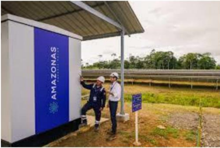
OPERACIÓN Y MANTENIMIENTO
