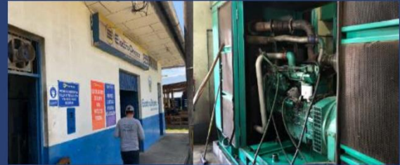
Planta Térmica de Tamshiyacu
