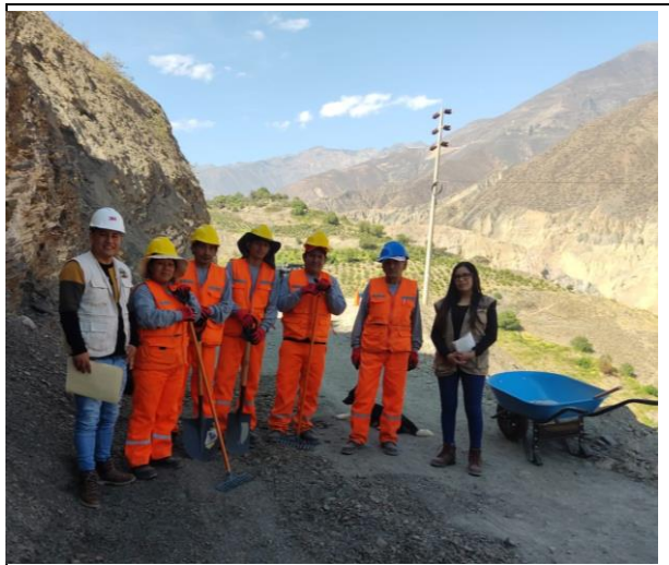
Foto 02: CHARLA DE CAPACITACION AL PERSONAL DE TRBAJO A CARGO DEL MANTENIMIENTO VIAL RUTINARIO DEL CAMINO VECINAL
