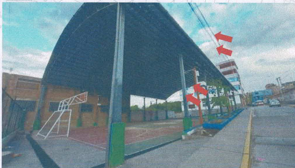
Fig. 01. Se evidencia la NO ejecución de la partida 01.05.05 conexión publica de electricidad
