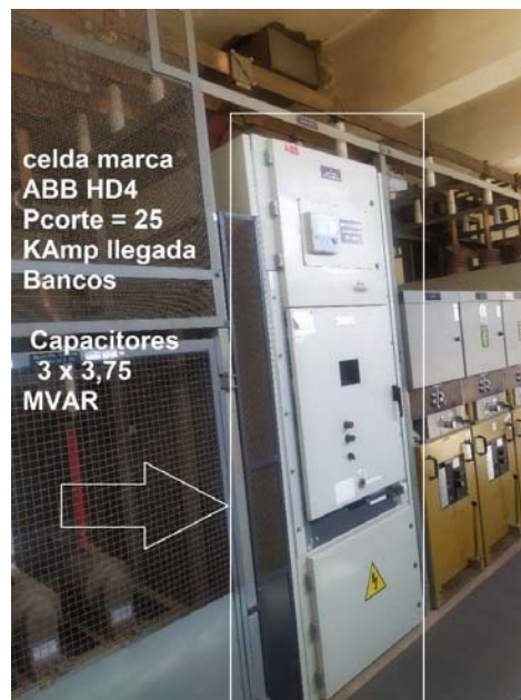
USO ACTUAL: LLEGADA BANCOS CONDENSADORES 3x 3,75 MVAR A REMOVER POR CONEXIÓN A BARRA EXPUESTA
