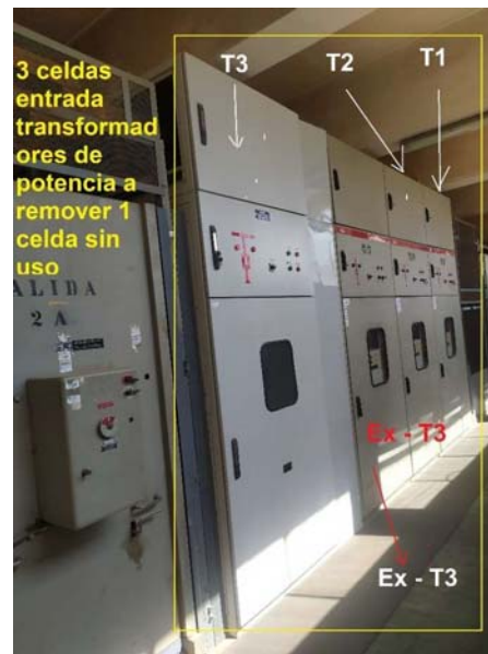
USO ACTUAL 03 CELDAS: Entrada 03 Trafos de potencia Barra en parte superior, existe una celda sin uso por PIT del 2016
