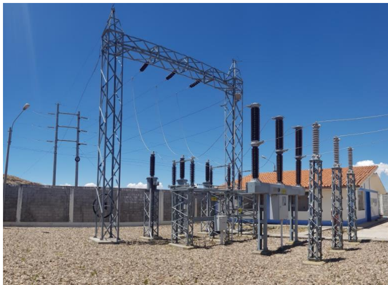
Figura 2 Vista del patio de llaves de la subestación Ilave
