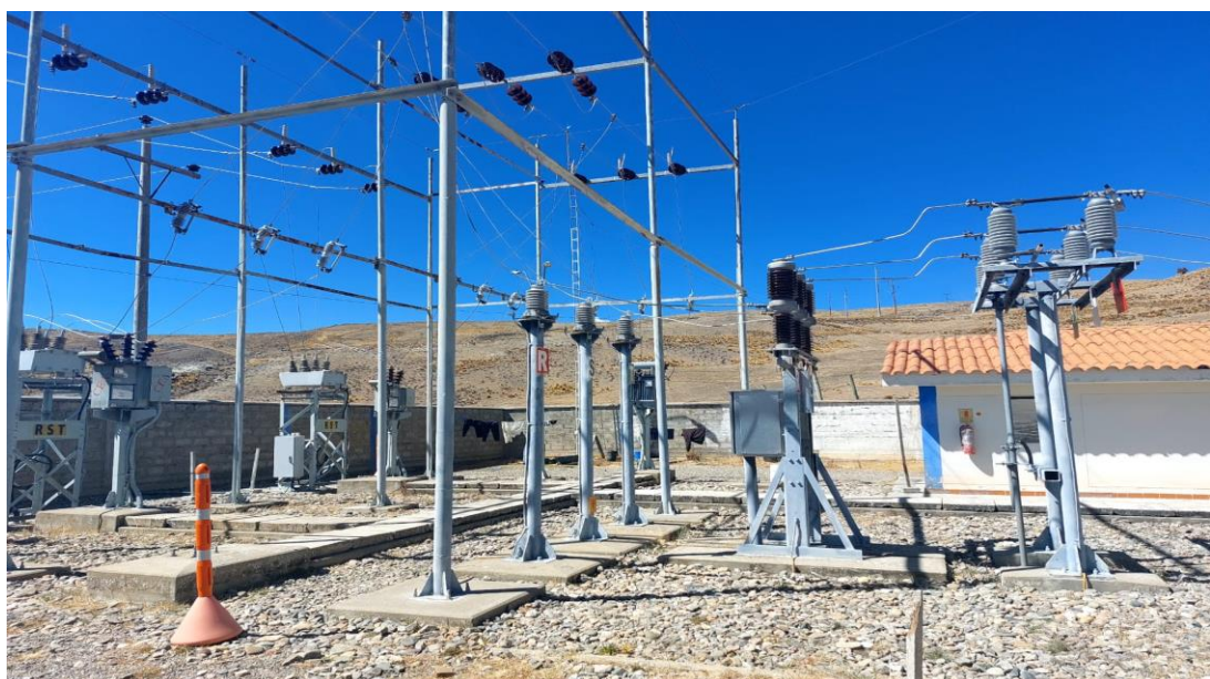
Figura 10 Vista del patio de llaves de la subestación Antauta
