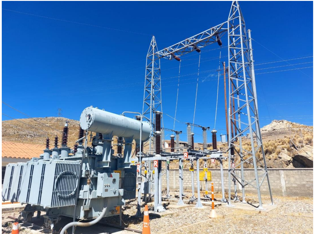
Figura 11 Vista de la ubicación del transformador 60/22.9 kV
