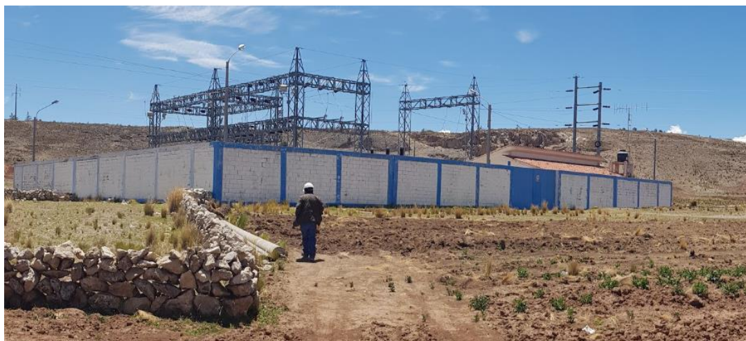
Figura 3 Vista del perímetro de la subestación Ilave
