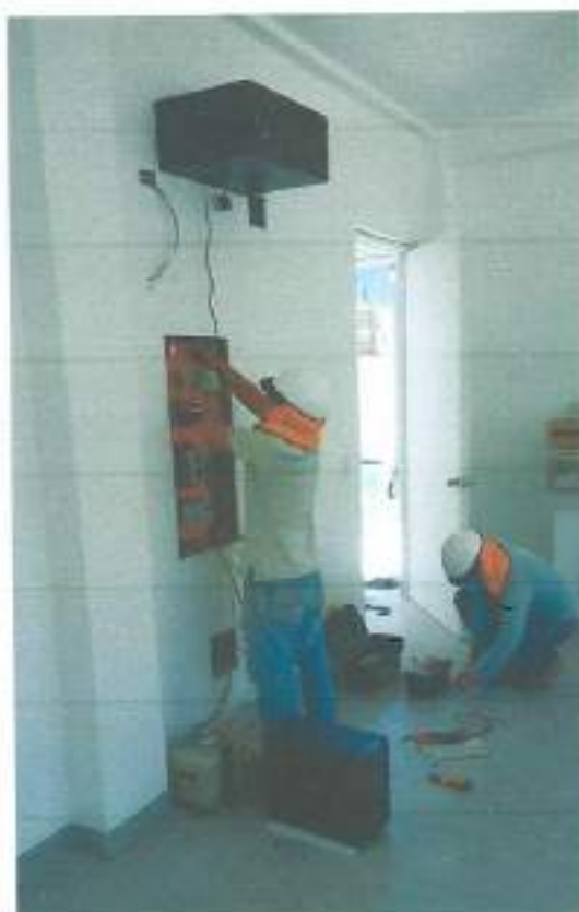
TRANSFORMADOR DE AISLAMIENTO DE 3 Kw/ UPS DE 3 kw/GABINETE METALICO DE COMUNICACIONES
