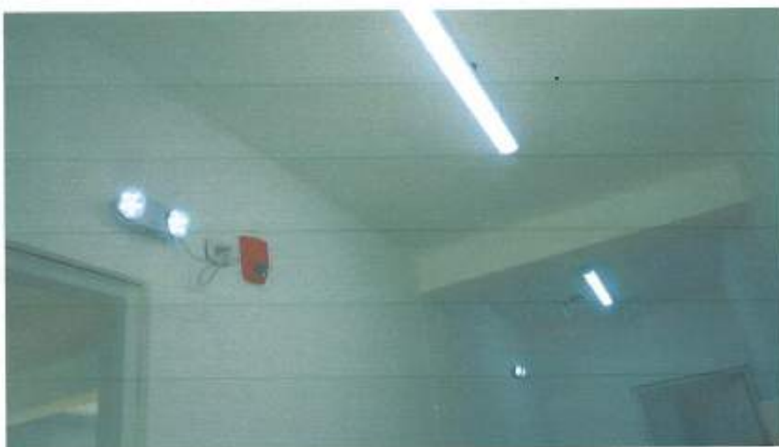
ILUMINACION INTERIOR-LUCES DE EMERGENCIA- LUZ ESTROBOCOPICA CON ALARMA
