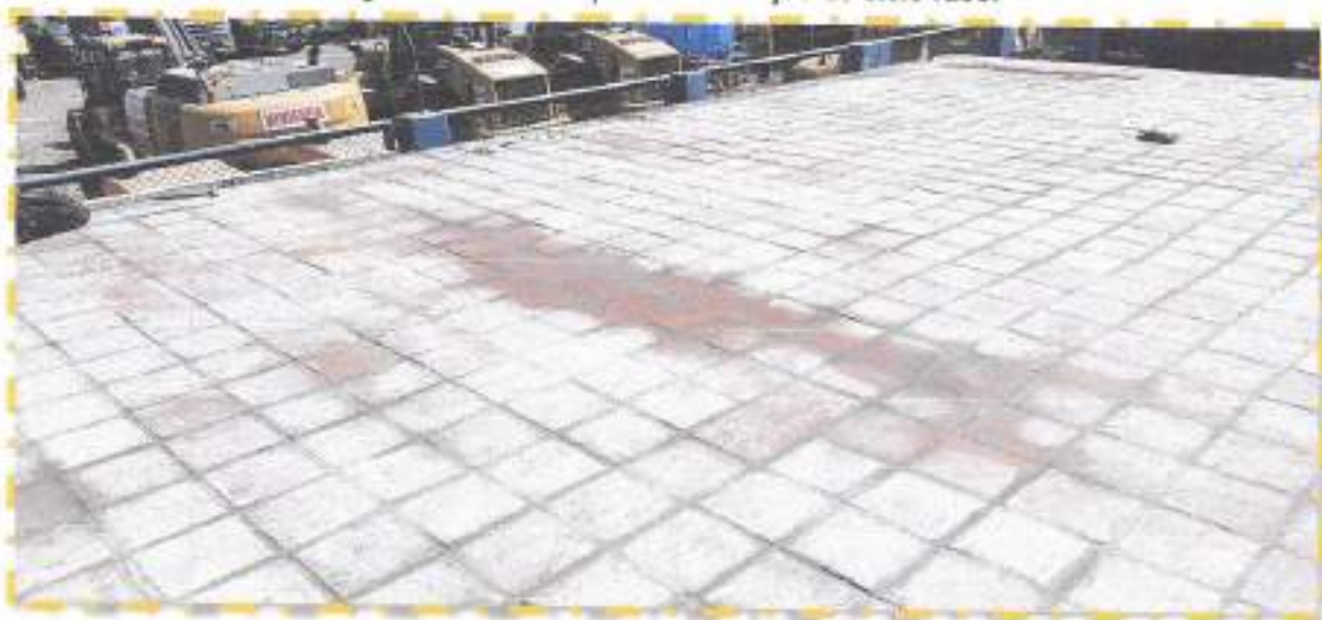
Fotografía N° 13: se aprecia el ladrillo pastelero en el techo.
