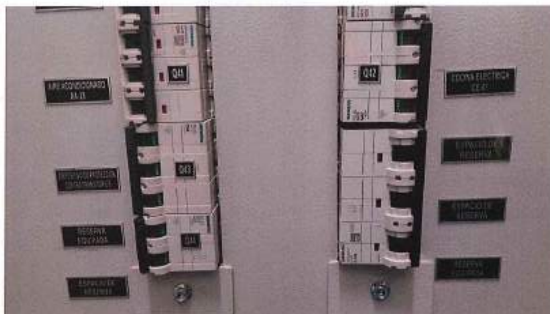
Fotografía N° 10 SALIDA DE INTERRUPTOR TERMOMAGNETICO DE 3X100AMP.
