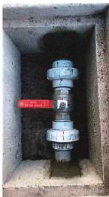
Fotografía N° 06 VALVULA DE BOLA DE 2"
