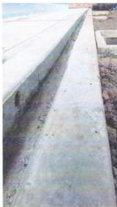
Fotografía N° 07 SALIDA DE DRENAJE DE AGUA DE CANALETA SINFIN DE Ø2"
