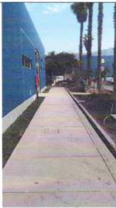
Fotografía N° 01 JUNTA EN VEREDA E=1/2" CON SELLO FLEXIBLE
