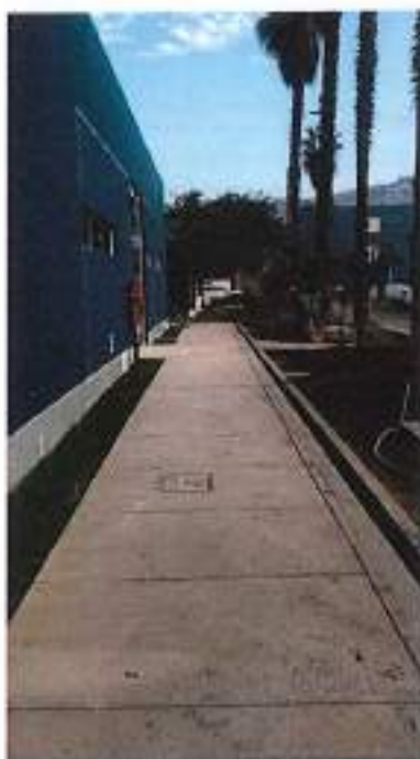
Fotografía N° 01 JUNTA EN VEREDA E=1/2" CON SELLO FLEXIBLE
