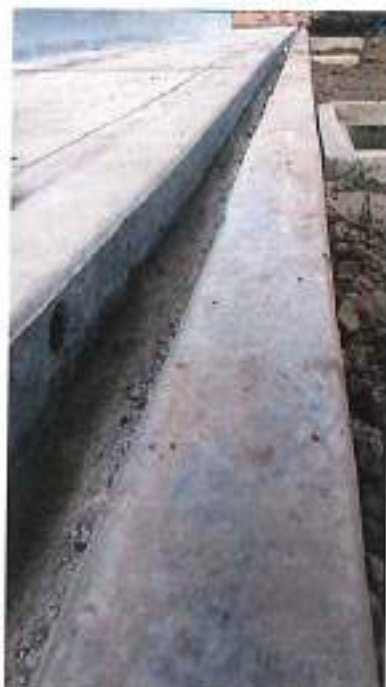
Fotografía N° 07 SALIDA DE DRENAJE DE AGUA DE CANALETA SINFIN DE Ø2"
